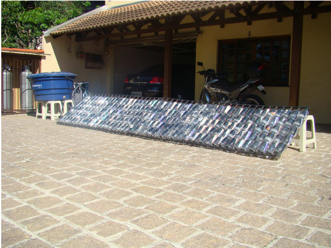
Figura 46 - Painel protótipo interligado com a caixa d'água Fonte: ARQUIVO PESSOAL, 2011
