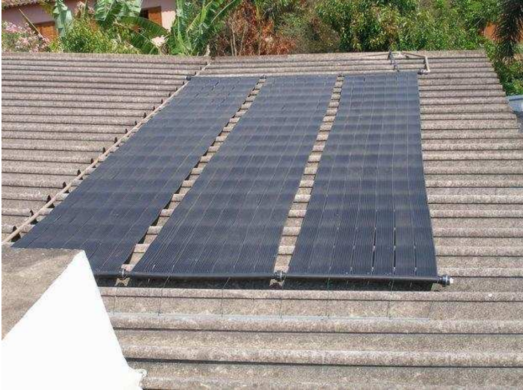
Figura 17 - Aquecedor solar residencial em Belo Horizonte (MG) FONTE: BHSolar, 2011
