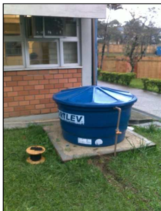
Figura 42 - Caixa de água inferior em que a bomba foi instalada.
