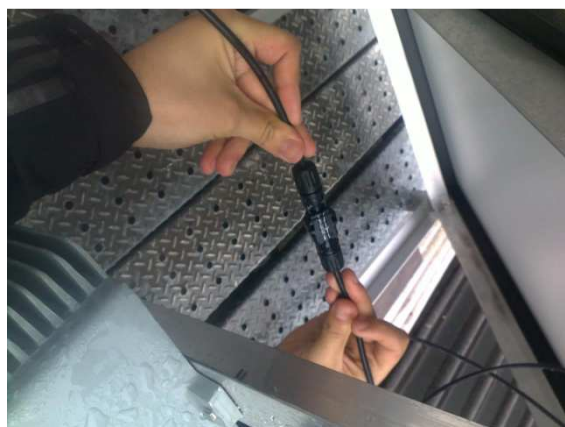
Figura 36 - Conexão em série dos módulos fotovoltaicos.
