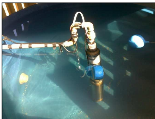
Figura 30 - Bomba Solarjack SCS instalada em campo.
