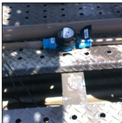
Figura 44 – Hidrômetro instalado próximo a caixa de água superior
