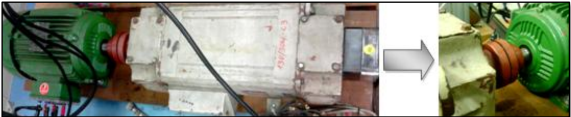
Figura 49 - Acoplamento Motor-Gerador Fonte: Autoria própria
