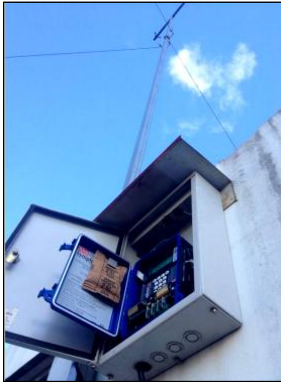
Figura 26 - Disposição do Data Logger e dos Sensores de Medições Instalados na UTFPR Fonte: COSTA, 2014.
