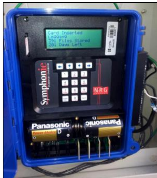
Figura 25 - Data Logger Instalado na UTFPR Fonte: COSTA, 2014.
