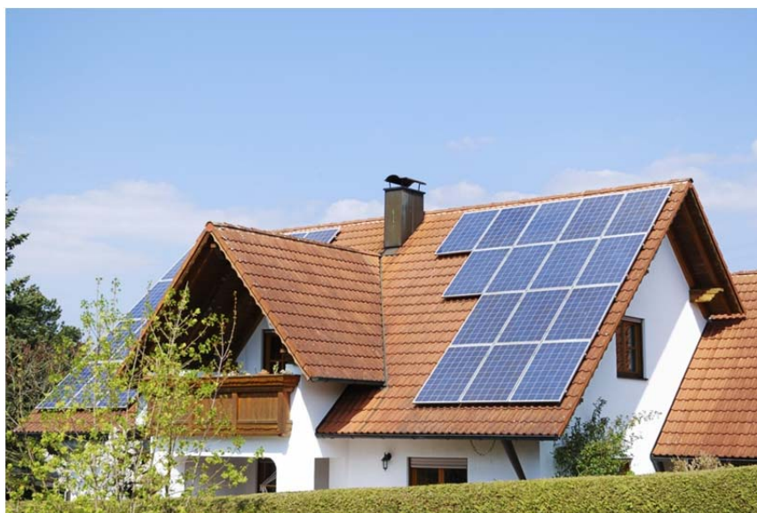
Figura 14 - Exemplo de um sistema fotovoltaico distribuído conectado à rede elétrica Fonte: Master Solar, 2014.
