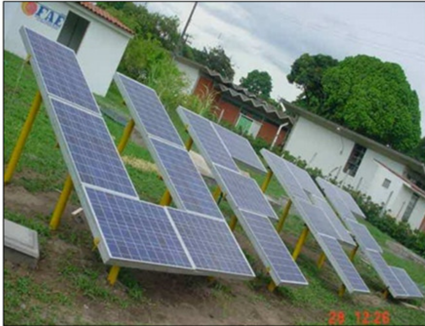
Figura 20: SFVR com backup de energia da UFPE Fonte: Barbosa; Silva; Melo, 2007
