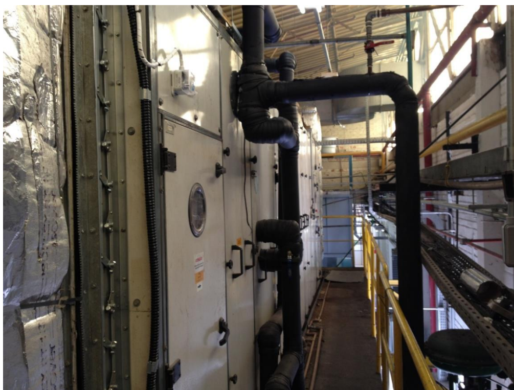
Figura 17 - Serpentina do sistema de climatização da cabine de pintura.
