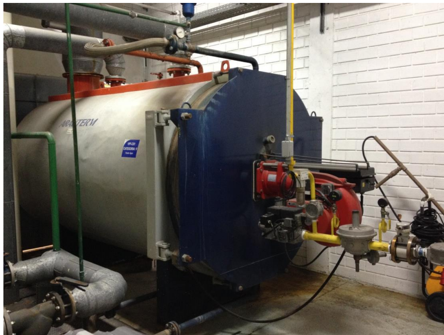
Figura 11 - Boiler da fábrica 1 da Electrolux do Guabirota.
