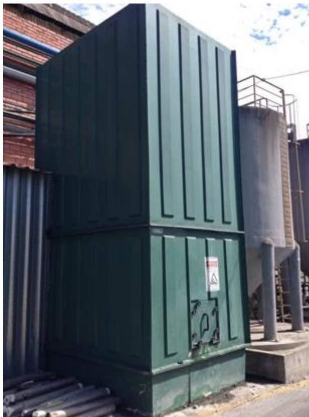
Figura 16 - Torre de resfriamento do chiller.
