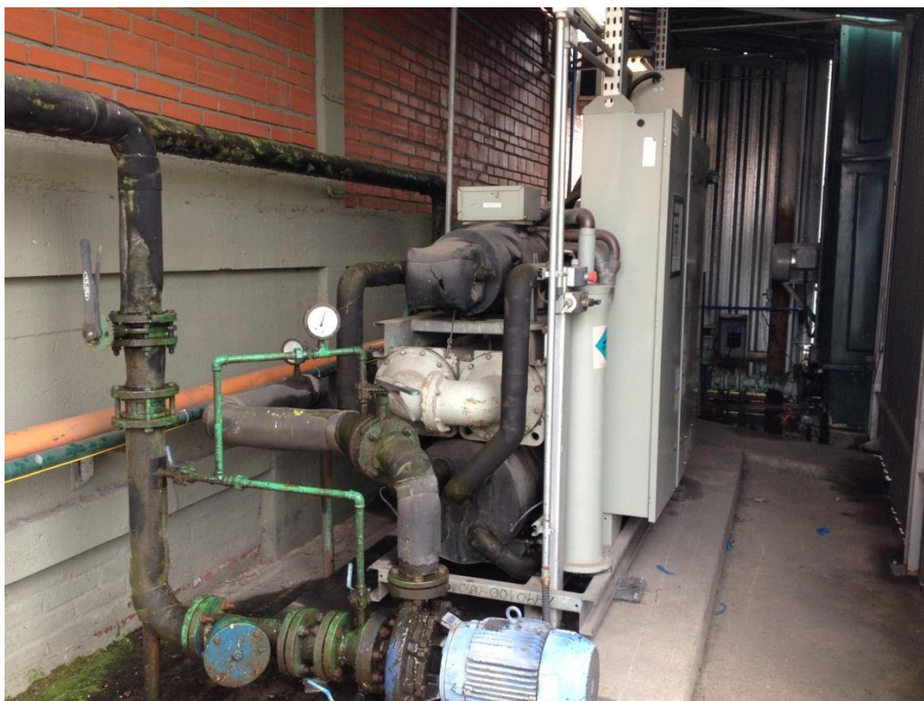
Figura 15 – Chiller de compressão da cabine de pintura da fábrica 1.
