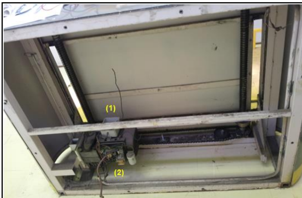
Figura 27 - Motor e mecanismos da plataforma elevatória Fonte: Autoria própria.
