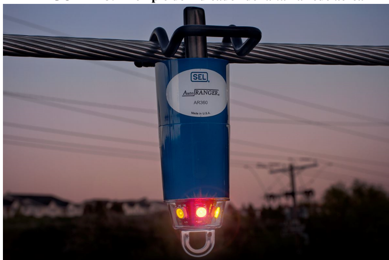
FIGURA 18: Exemplo de indicador de falta na rede aérea
