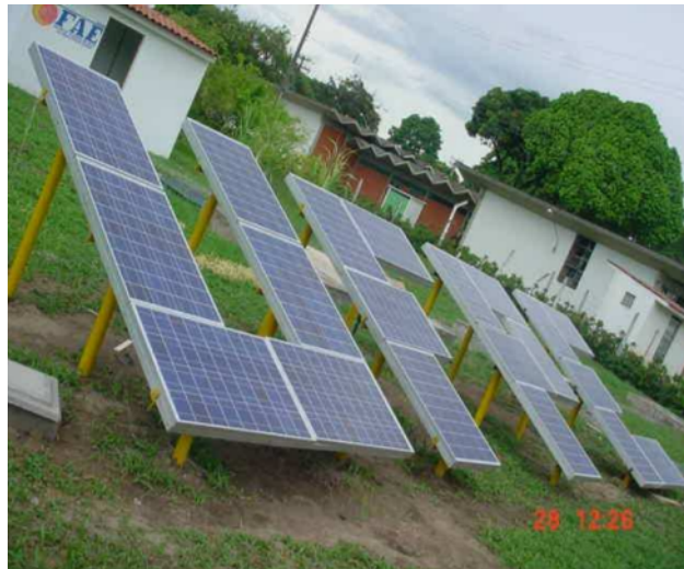
FIGURA 22: Sistema fotovoltaico conectado à rede
