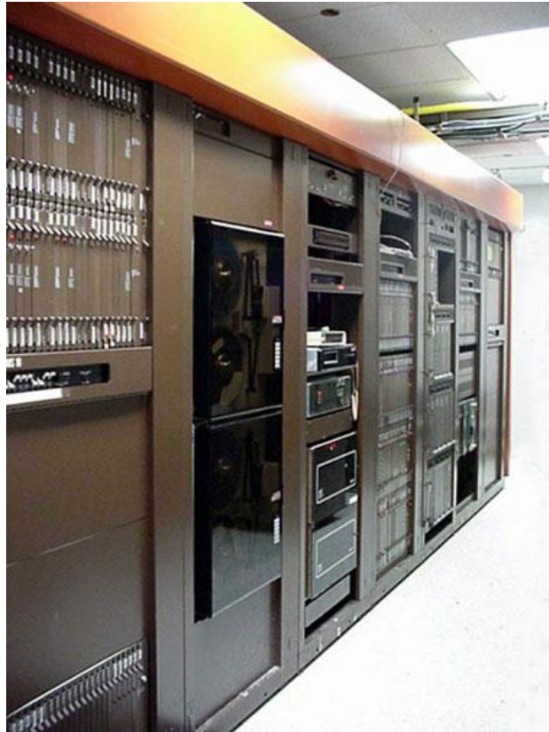
Figura 38 – Nortel Switch DMS-100 Fonte: Nortel (2002)
