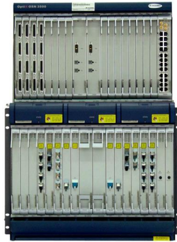
Figura 20 - Sub-rack do Optix OSN 3500 Fonte: Huawei (2006)
