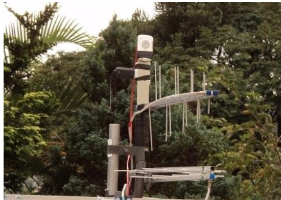
Figura 05 – Foto da antena receptora instalada na vertical e horizontal
