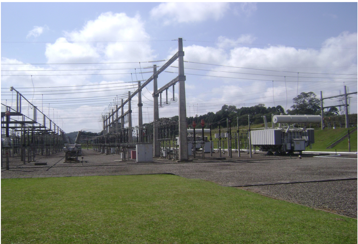
Fotografia 1 – Subestação Bateias 525 kV Fonte: Autoria própria.
