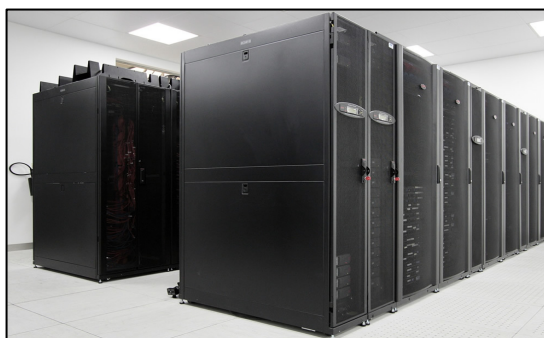
Fotografia 1 – Central TDM Fonte: Flesk Telecom (2012)
