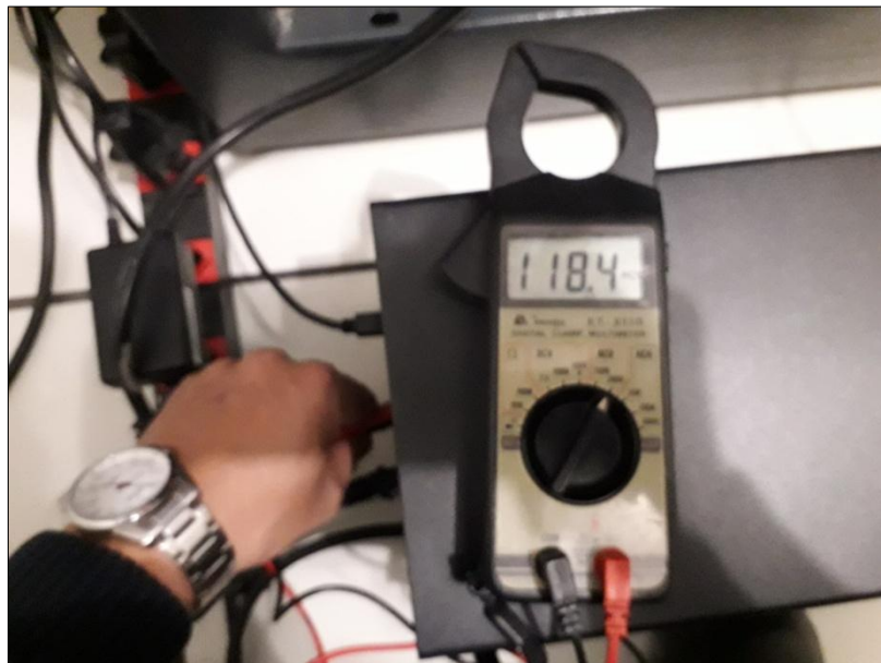
Tensão da tomada do no-break (com a carga da bateria) – tarde
