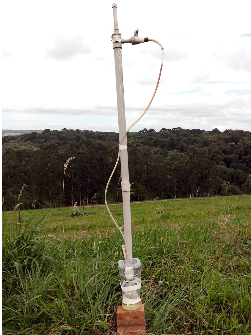
Figura 5. Foto do Sistema I instalado no aterro sanitário
