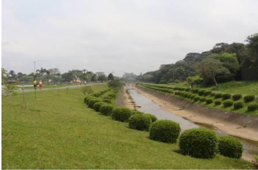
Figura 5 – Passagem do Rio Bacacheri pelo Parque, demonstrando a canalização realizada por intervenções de engenharia no local, bem como a ausência de área de preservação permanente (mata ciliar) no entorno do rio, e a presença de vegetação exótica oriunda do paisagismo implantado pela Secretaria Municipal de Meio Ambiente de Curitiba. Fonte: Autoria própria.
