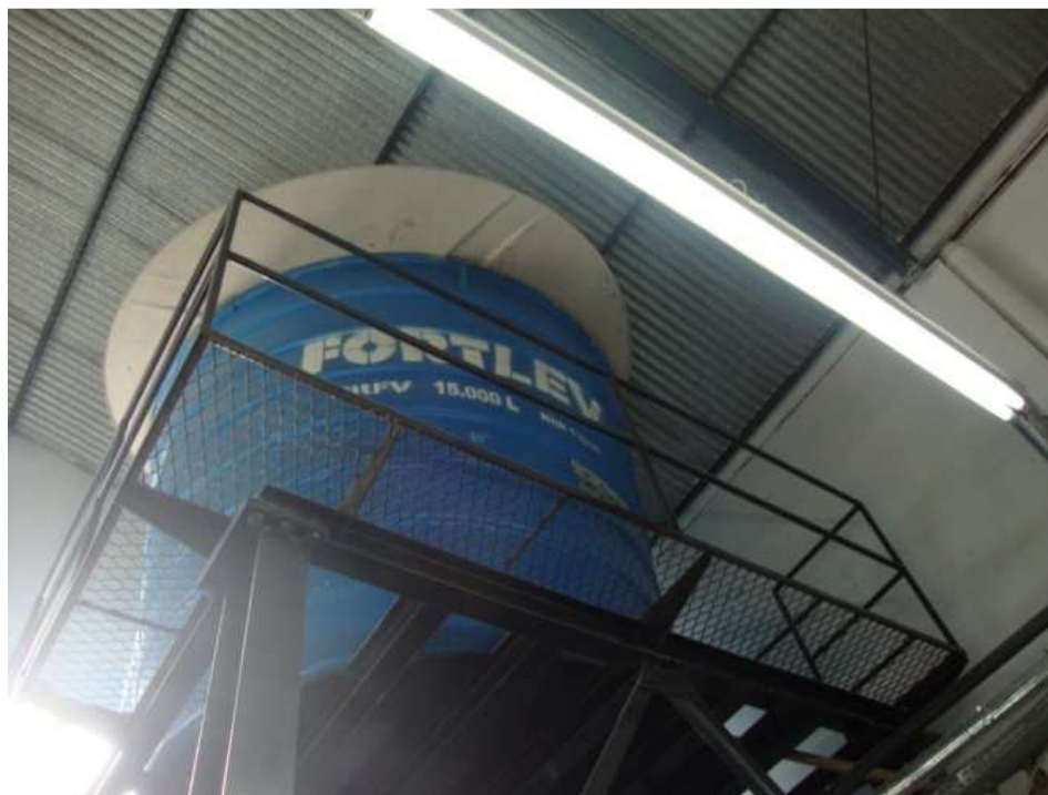
Figura 15 – Tanque para água de reuso.
