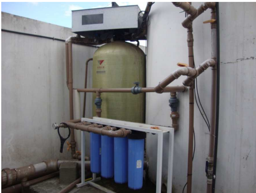
Figura 4 – Estação de Tratamento de Afluentes
