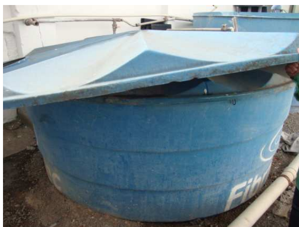
Figura 9 – Tanque do lodo;
