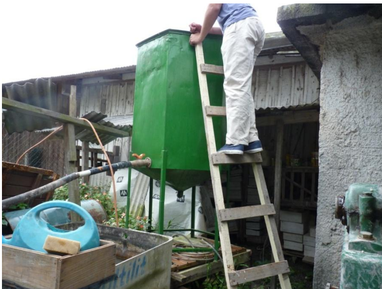
Figura 18 - Decantador montado pelo próprio empresário para tratamento da água de chuva.
