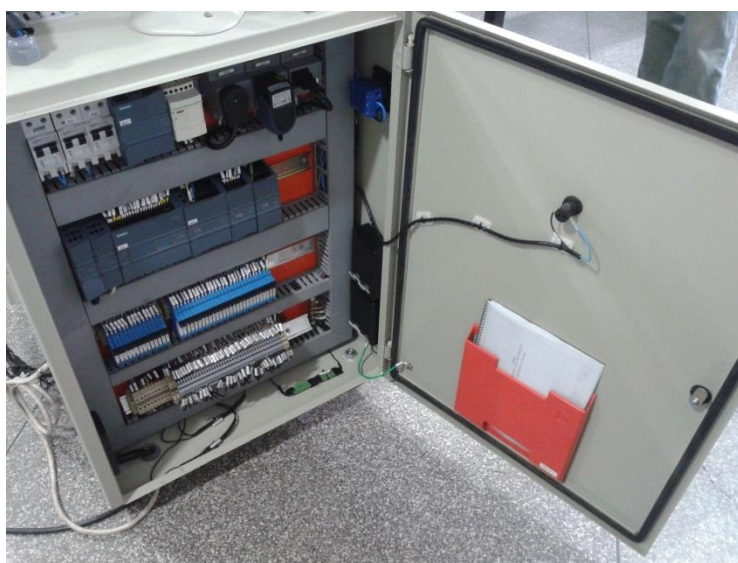
Figura 19 - Fotografia do painel elétrico aberto. Fonte: Autoria própria.
