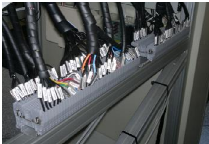
Figura 34 - Bornes Elétricos. Fonte: Autoria própria.
