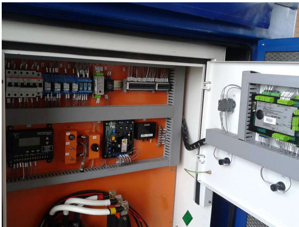
Figura 32 - Painel de comando após montagem e acoplamento no GMG Fonte: Autoria própria.
