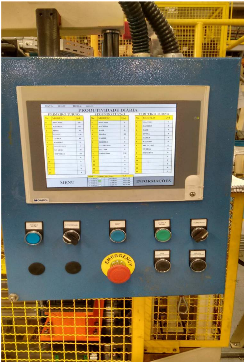
Imagem 3 – Painel de comando Fonte: Autoria própria
