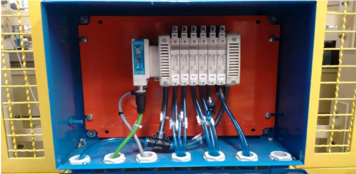
Imagem 4 – Bloco de Válvulas Fonte: Autoria própria
