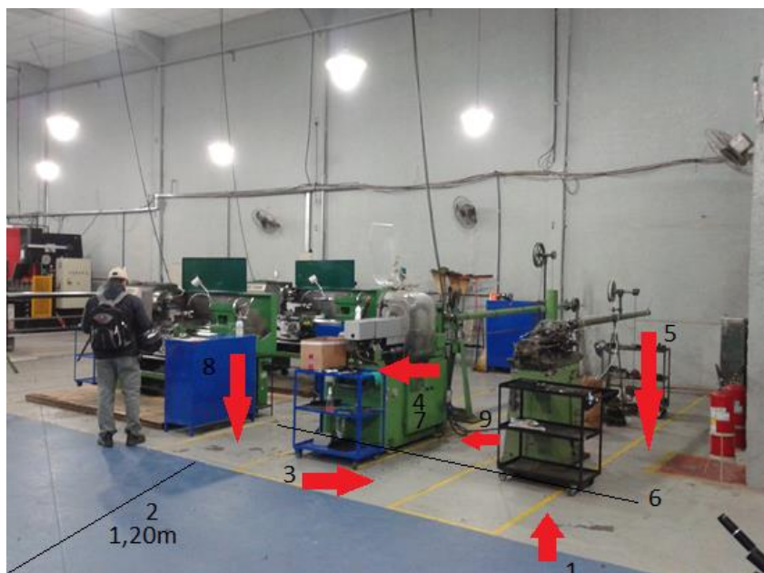
Figura 10 - Arranjo físico e instalações após a adequação a norma Fonte: Autoria própria.
