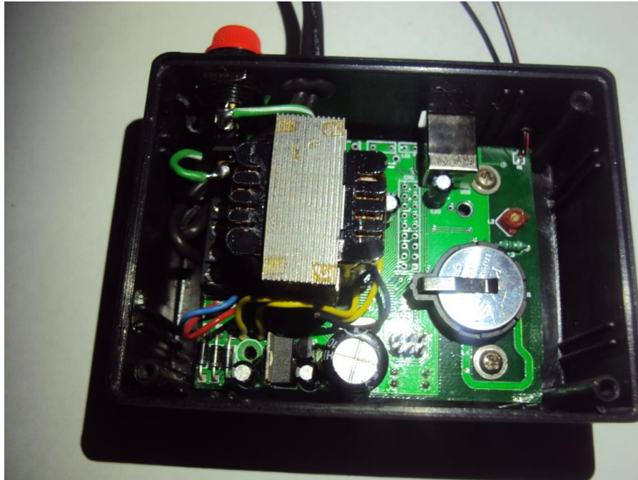
Figura 20 - Placa do módulo central montada em seu compartimento final. Fonte: Autoria própria.
