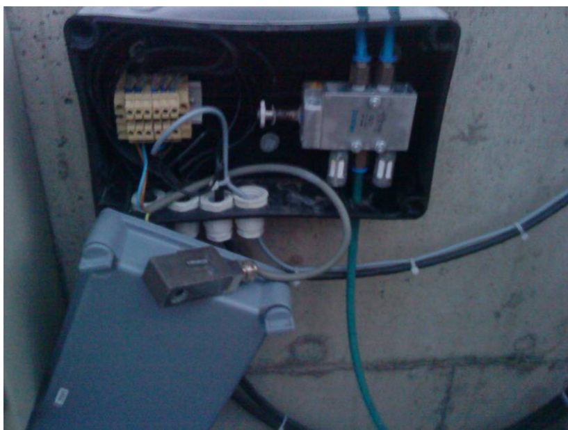
Fotografia 33 - Caixa de interligação de comando do solenoide, sensores de posição e válvula de comando da comporta VEP-9 Fonte: A autoria própria.
