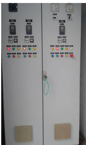
Fotografia 32 - Painel elétrico dos misturadores do tanque 4.3 Fonte: Autoria própria.
