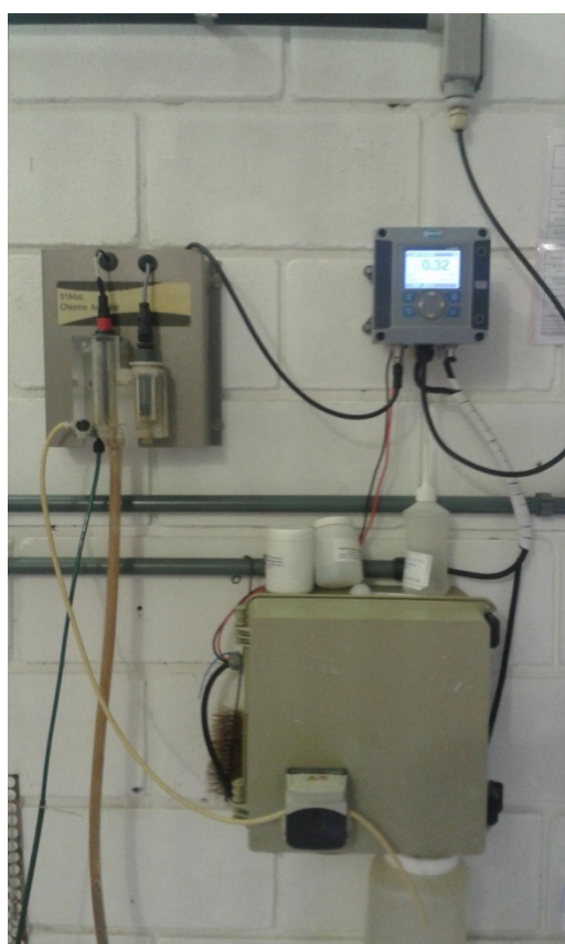
Fotografia 16 - Montagem do bulbo com o sensor de cloro, analisador de cloro livre e bomba de ácido clorídrico Fonte: Autoria própria.
