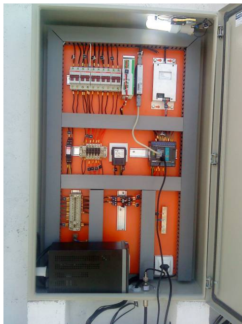
Fotografia 39 - Painel de telemetria padrão das elevatórias, a foto foi retirada da Elevatória EEH Fonte: Autoria própria.
