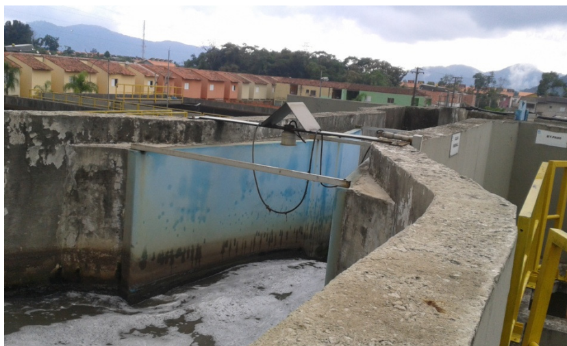
Fotografia 4 - Calha Parshall com medidor ultrassônico instalado Fonte: Autoria própria.
