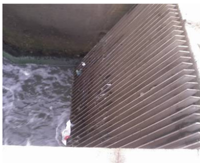
Fotografia 24 - Gradeamento de sólidos grosseiros da antiga entrada de esgoto da ETE. Fonte: Autoria própria.
