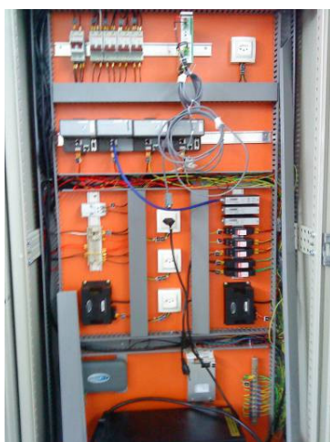
Fotografia 42 - Painel do concentrador de sinais CCR, no momento da foto a comunicação dos rádios estava sendo testada Fonte: Autoria própria.
