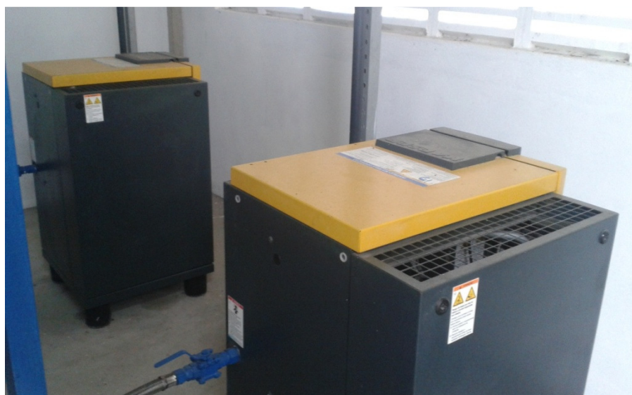
Fotografia 23 - Compressores de ar comprimido Fonte: Autoria própria.
