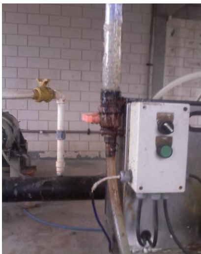
Fotografia 27 - Antiga dosadora de polímero e a antiga centrífuga de lodo ao fundo (lado esquerdo)
