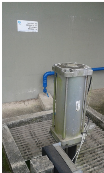
Fotografia 8 - Válvula VEP- 12 de descarte de efluente do tanque 4.2 Fonte: Autoria própria.
