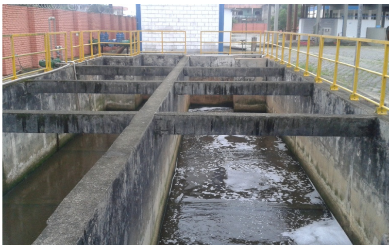
Fotografia 14 - Tanque de câmaras de contato. Ao fundo no lado esquerdo as bombas de arraste de cloro (BDA-01 e BDA-02) e do lado direito a VEP-17 Fonte: Autoria própria.
