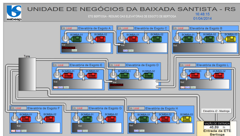
Imagem 12 - Tela do sistema de supervisão mostrando o resumo das elevatórias de esgoto Fonte: Autoria própria.
