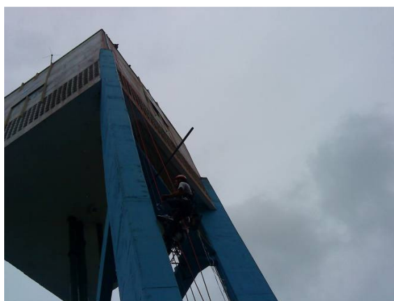
Fotografia 41 - Instalação dos eletrodutos que protegem os cabos de radiofrequência Fonte: Autoria própria.
