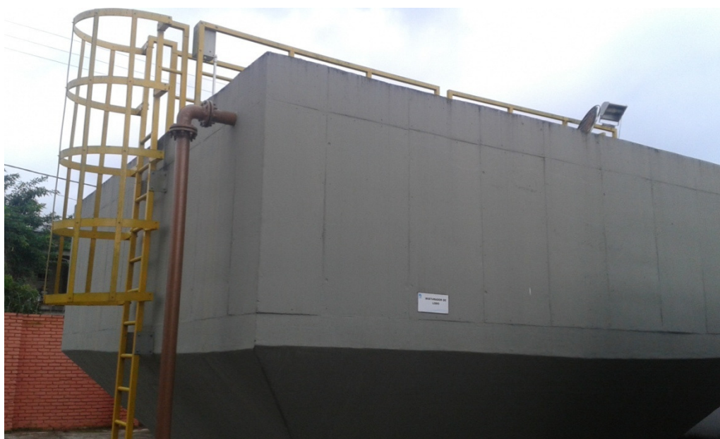
Fotografia 18 - Tanque de lodo adensado Fonte: Autoria própria.
