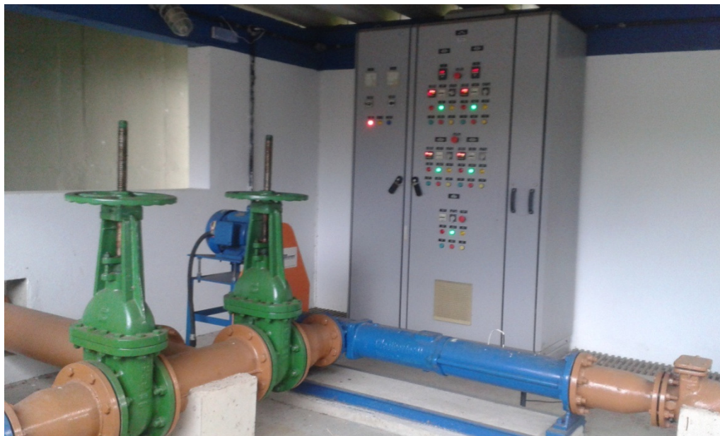
Fotografia 13 - Bombas de lodo e painel comando ao fundo Fonte: Autoria própria.
