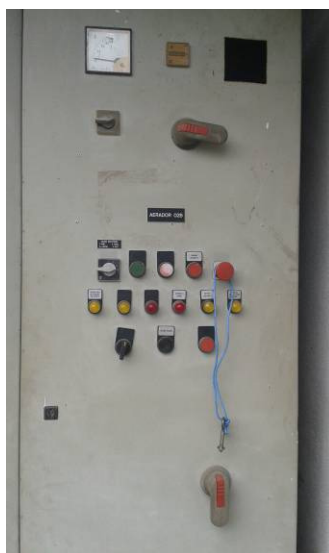
Fotografia 28 - Foto do painel de comando dos aeradores 4.1 A e B existente
