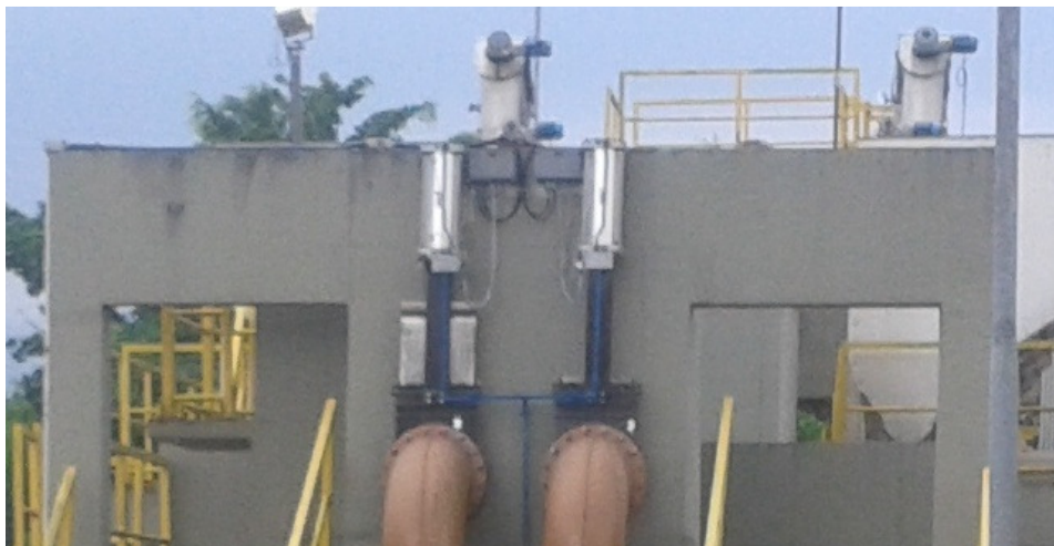
Fotografia 5 - Comportas de entrada do efluente bruto. a esquerda VEP-01 para os tanques 4.1 e 4.2 e a direita a VEP-02 para os tanques 4.3 e 4.4 Fonte: Autoria própria.
