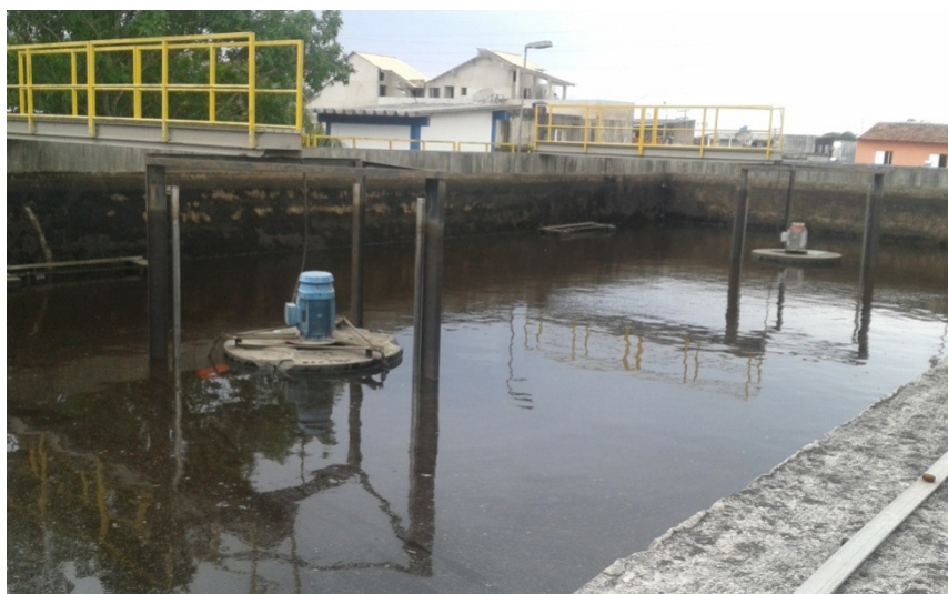
Fotografia 6 - Tanque de aeração 4.3 Fonte: Autoria própria.
