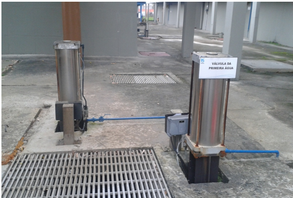
Fotografia 12 - Caixa de válvulas de primeira água Fonte: Autoria própria.
