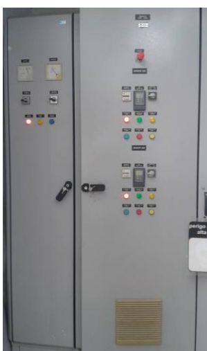
Fotografia 31 - Painel elétrico dos Aeradores do tanque 4.3 Fonte: Autoria própria.
