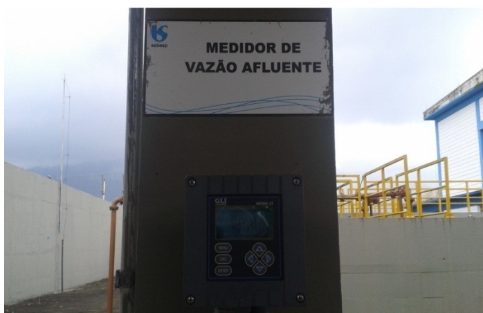
Fotografia 3 - Medidor de vazão de entrada de esgoto Fonte: Autoria própria.
