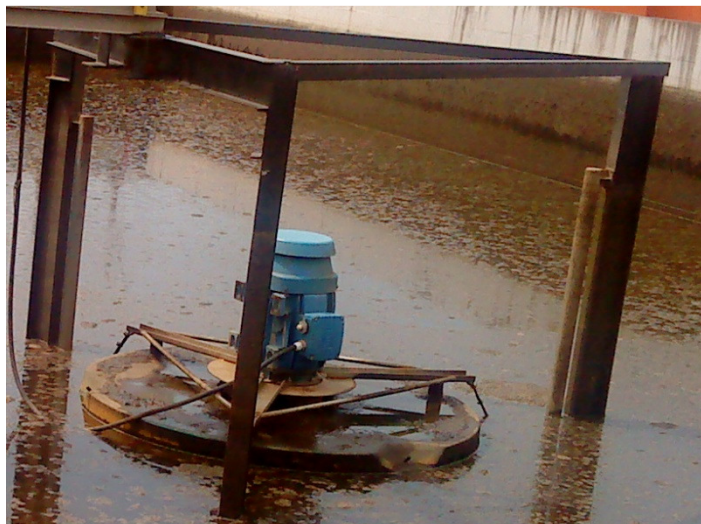
Fotografia 9 - Aerador AER – 4.3A Fonte: Autoria própria.
