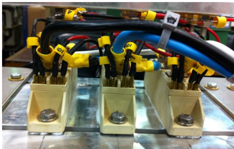
Figura 16 – Blocos de Tiristores Fonte: Próprio autor
