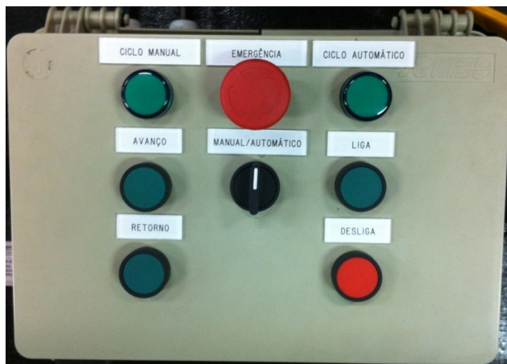
Figura 23 – Parte interna do Painel de Comando Fonte: Próprio autor
