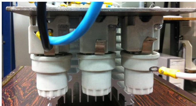
Figura 15 – Fusíveis de Proteção Fonte: Próprio autor
