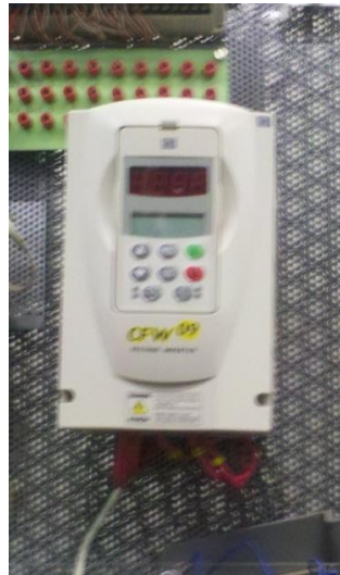
Figura 49 – Inversor CFW-09 do laboratório
