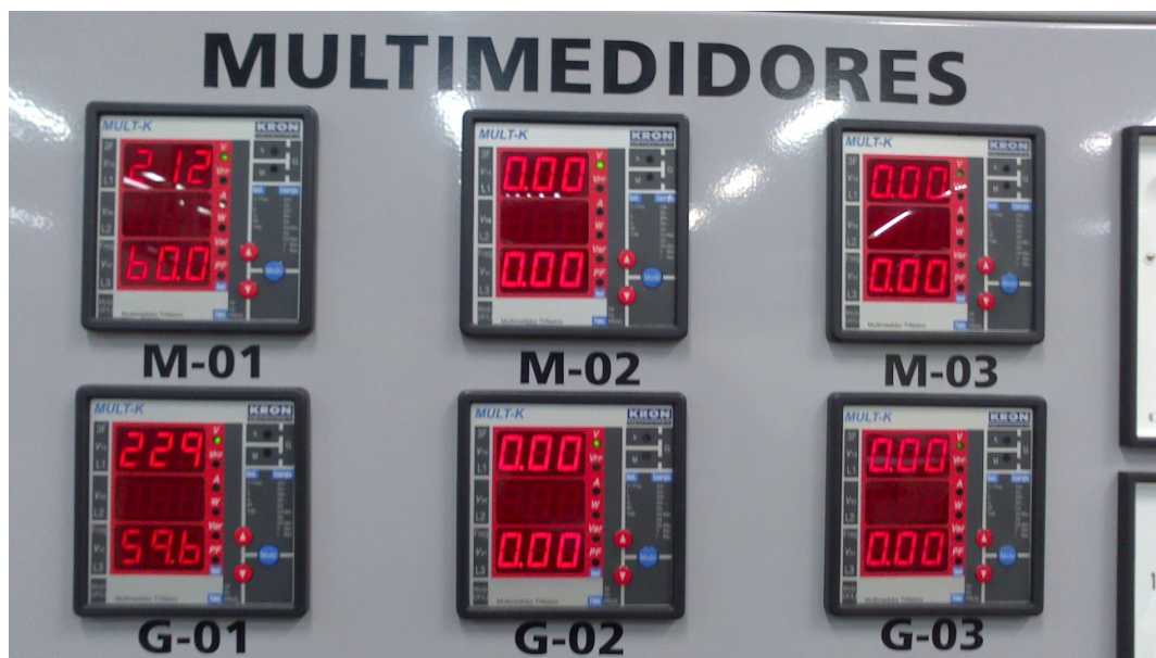
Figura 19 - Multimedidores Kron Fonte: Fonte Própria
