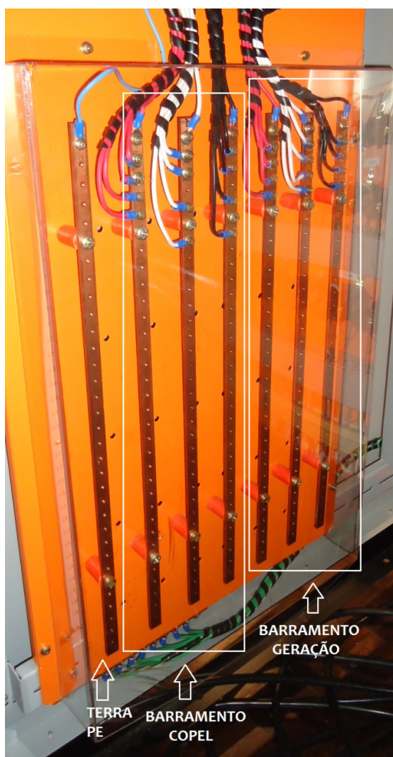
Figura 30 - Barramentos Fonte: Própria
