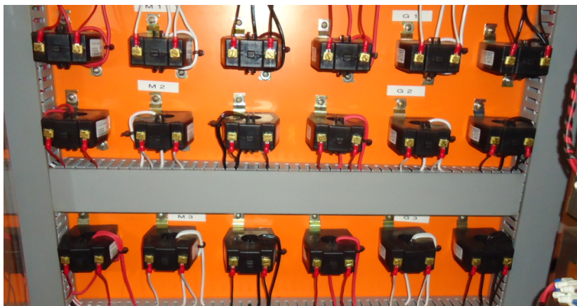
Figura 20 - Transformadores de Corrente Fonte: Fonte Própria
