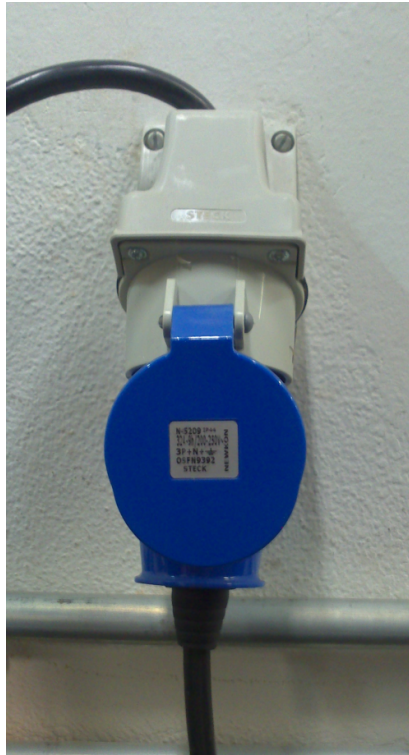
Figura 18 - Tomada de alimentação do painel Fonte: Própria
