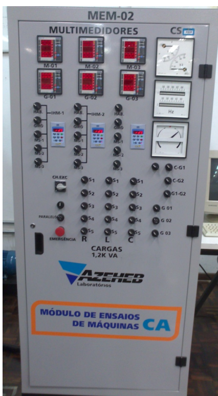
Figura 17 - Painel AZEHEB Fonte: Fonte Própria
