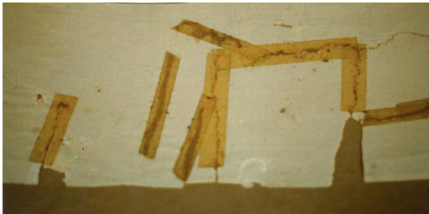
Figura 45 - Intervenções inadequadas: fita adesiva
