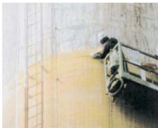
A aplicação de fibras de Kevlar em torno de um tanque de concreto.
