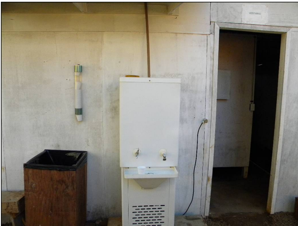
FOTO 18 – Bebedouro da obra G (Obra Grande porte)
