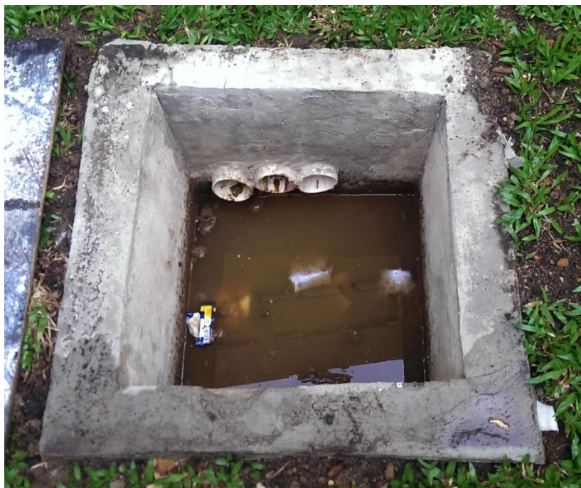
Figura 20 - Caixa de inspeção onde foi realizada a coleta de esgoto. Fonte: Autoria própria.
