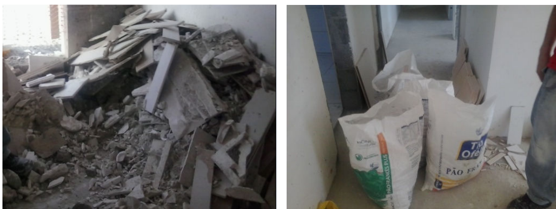
Figura 6 - Resíduo de gesso na obra.
