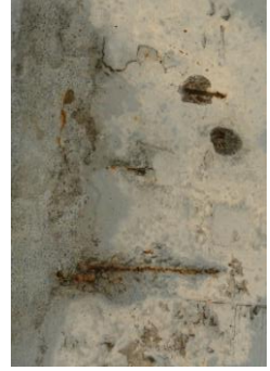
OXIDAÇÃO DA ARMADURA DA LAJE INFERIOR DA VIGA CAIXÃO
