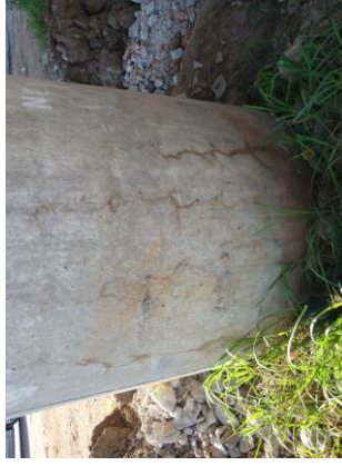
FISSURAS NO PILAR
