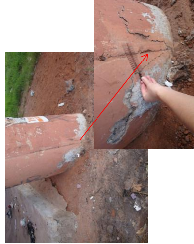
DESAGREGAÇÃO DO CONCRETO NA BASE DO PILAR
