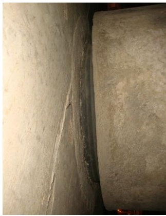
EXTREMIDADES DO APARELHO DE APOIO ABAULADAS
