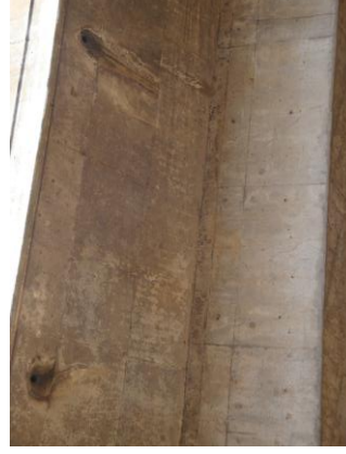
INFILTRAÇÃO NA DIREÇÃO DOS DRENOS
