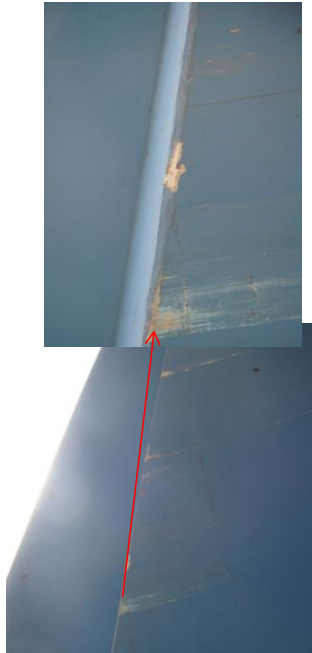
LIXIVIAÇÃO NA VIGA CAIXÃO
