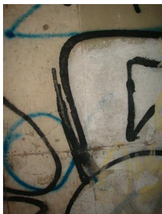
FISSURA NA LATERAL DA VIGA CAIXÃO
