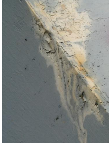
INFILTRAÇÃO NA VIGA CAIXÃO
