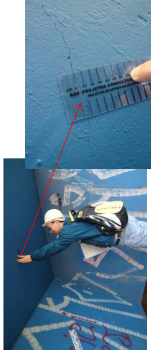
FISSURA NA LAJE EM BALANÇO
