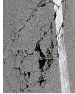
FALHA NO PAVIMENTO
