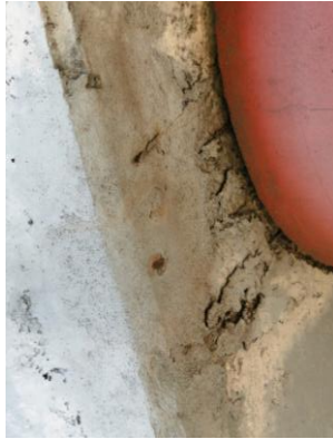
ARMADURA EXPOSTA NA VIGA CAIXÃO NO APOIO NO PILAR
