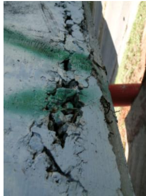
NINHO DE CONCRETAGEM COM ARMADURA EXPOSTA
