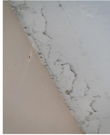
DESAGREGAÇÃO DO CONCRETO ENTRE VIGA CAIXÃO E LAJE EM BALANÇO
