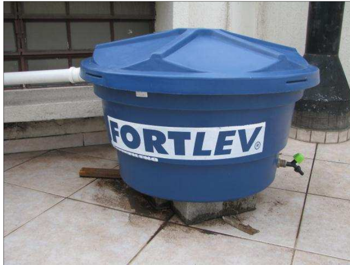
Figura 5 – Reservatório da água de chuva Fonte: Hirt e Santos (2011).
