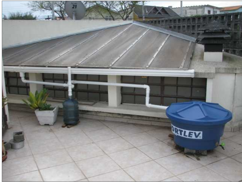
Figura 2 – Vista frontal do sistema de captação da água de chuva Fonte: Hirt e Santos (2011).
