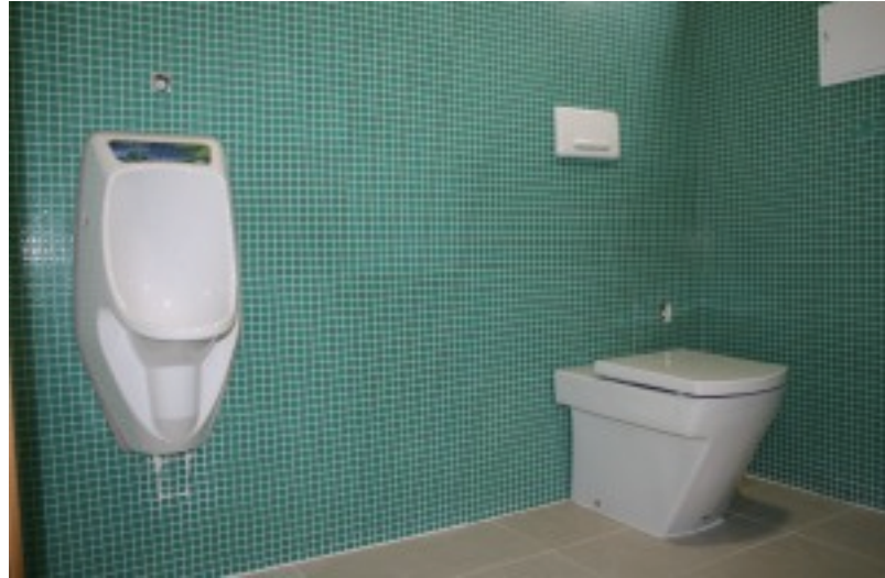
Figura 7- Detalhe do mictório que não utiliza água e descarga com dois fluxos FONTE: (ESCRITÓRIO VERDE ONLINE, 2012)
