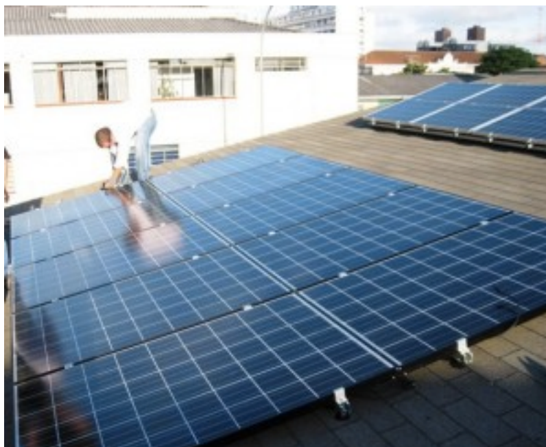
Figura 6 - Painéis fotovoltaicos instalados no telhado da edificação FONTE: (ESCRITÓRIO VERDE ONLINE, 2012)
