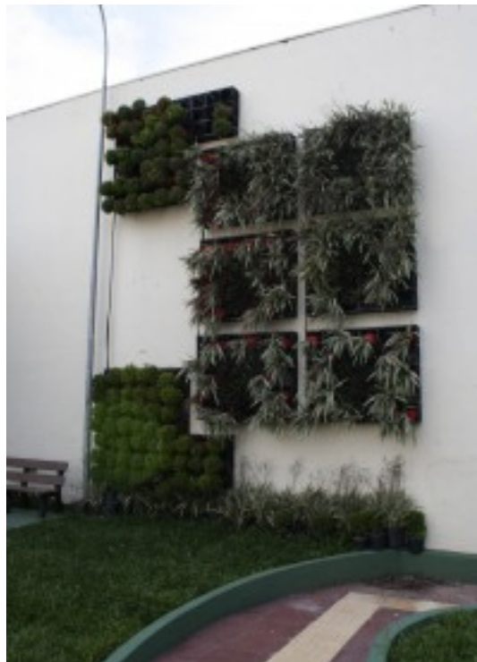
Figura 8 - Jardim instalado na parede da edificação vizinha FONTE: (ESCRITÓRIO VERDE ONLINE, 2012)
