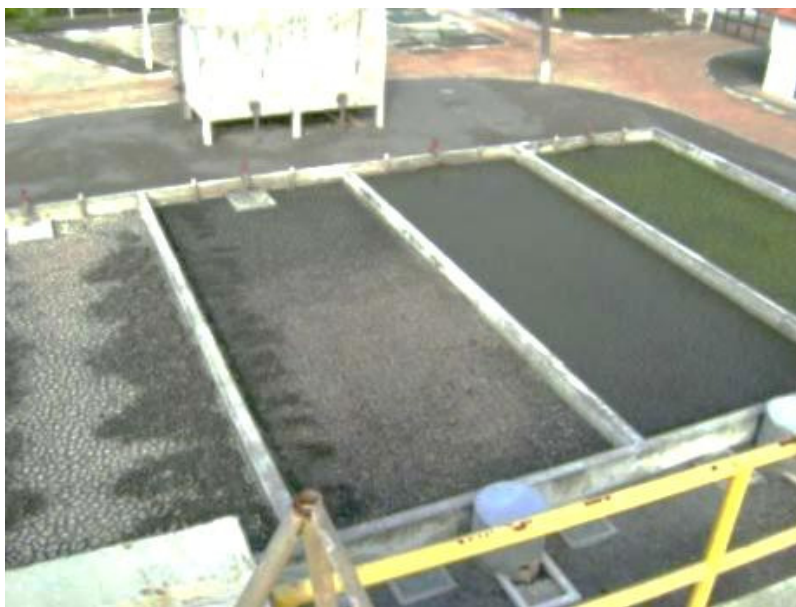
Figura 5 – Estação de Tratamento EMBASA IBEROSTAR, sistema tipo híbrido associado DAFA. Fonte: FH Engenharia (2012).
