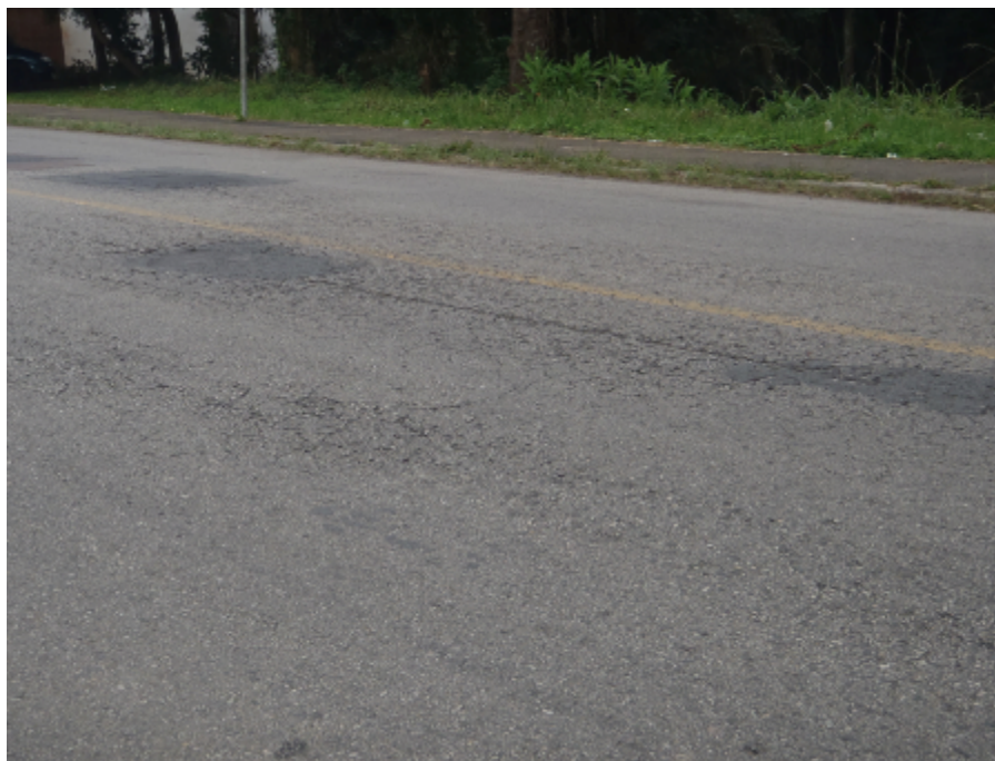
FIGURA 25 - TRECHO 2 CAP 50/70: TRINCAS INTERLIGADAS E REMENDOS
