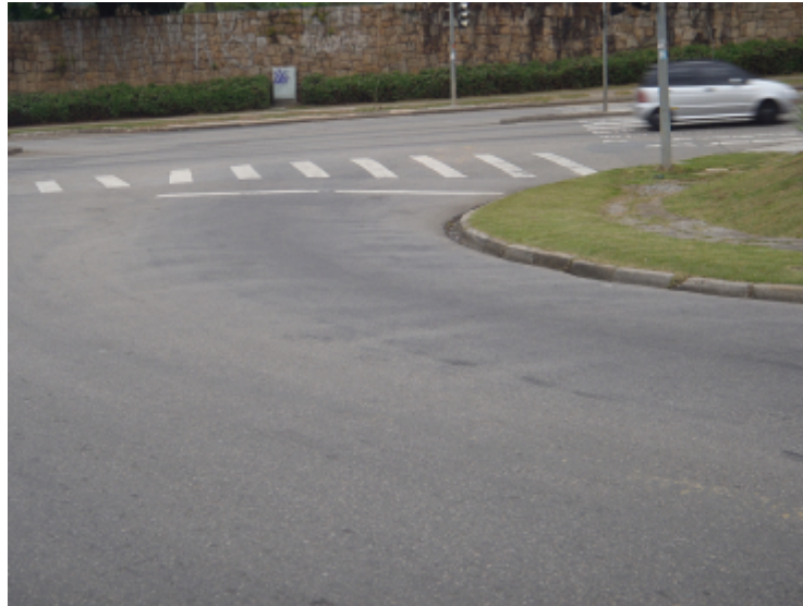
FIGURA 34 - TRECHO 2 AB8: AFUNDAMENTO E ONDULAÇÃO POR TRILHO DE RODA DEVIDO A FRENAGEM
