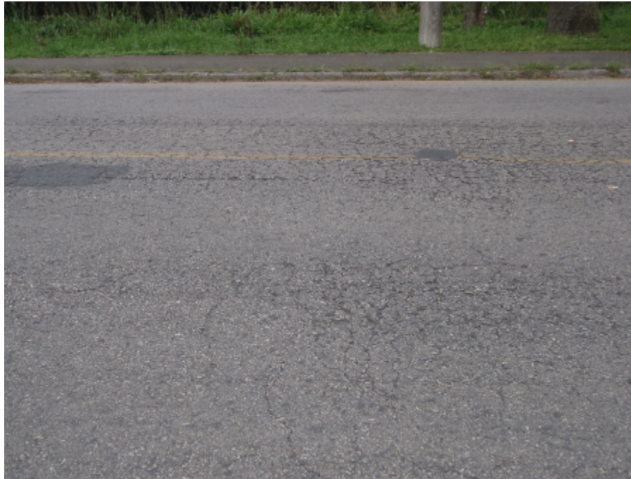
FIGURA 24 - TRECHO 2 CAP 50/70: TRINCAS INTERLIGADAS E REMENDOS
