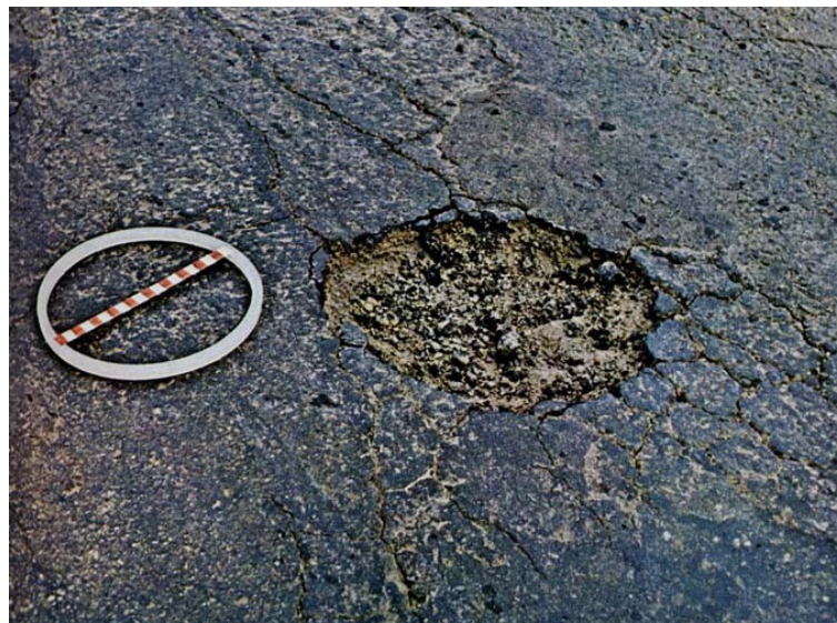
FIGURA 11 – PANELA OU BURACO
