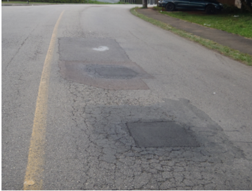
FIGURA 26 - TRECHO 2 CAP 50/70: REMENDOS EM BURACOS E TRINCAS INTERLIGADAS FONTE: AUTOR (2012)
