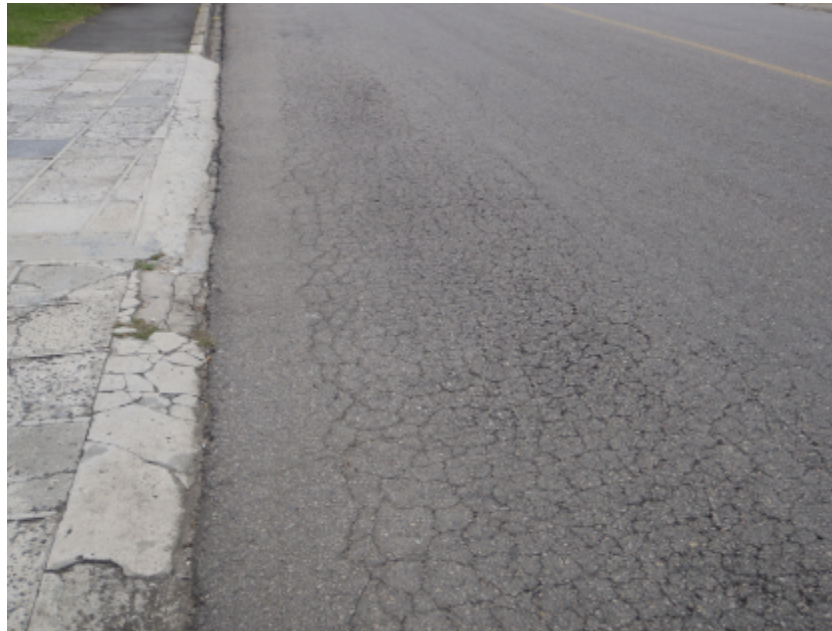
FIGURA 19 - TRECHO 1 CAP 50/70: TRINCAS INTERLIGADAS - "COURO DE JACARÉ"
