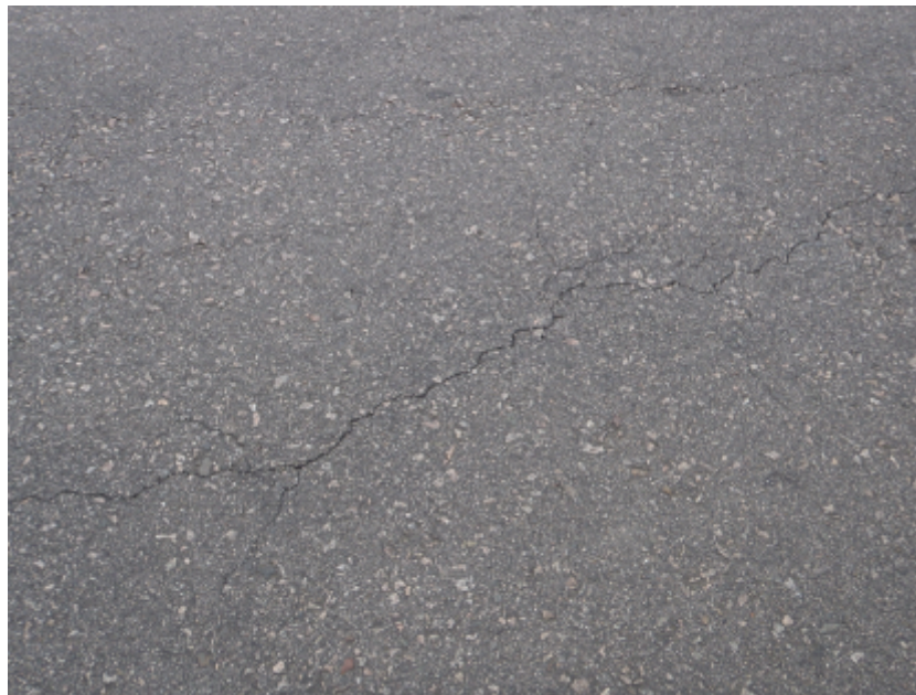
FIGURA 23 - TRECHO 1 AB8: TRINCA LONGITUDINAL ASSOCIADA A TRABALHABILIDADE DO PAVIMENTO
