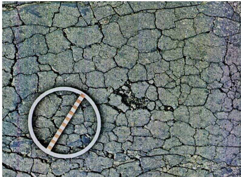
Figura 4 - Trinca "couro de jacaré"
