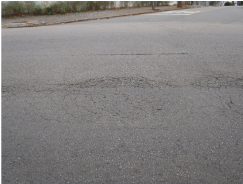
FIGURA 27 - TRECHO 2 CAP 50/70: TRINCAMENTO TIPO COURO DE JACARÉ ASSOCIADO COM AFUNDAMENTO FONTE: AUTOR (2012)
