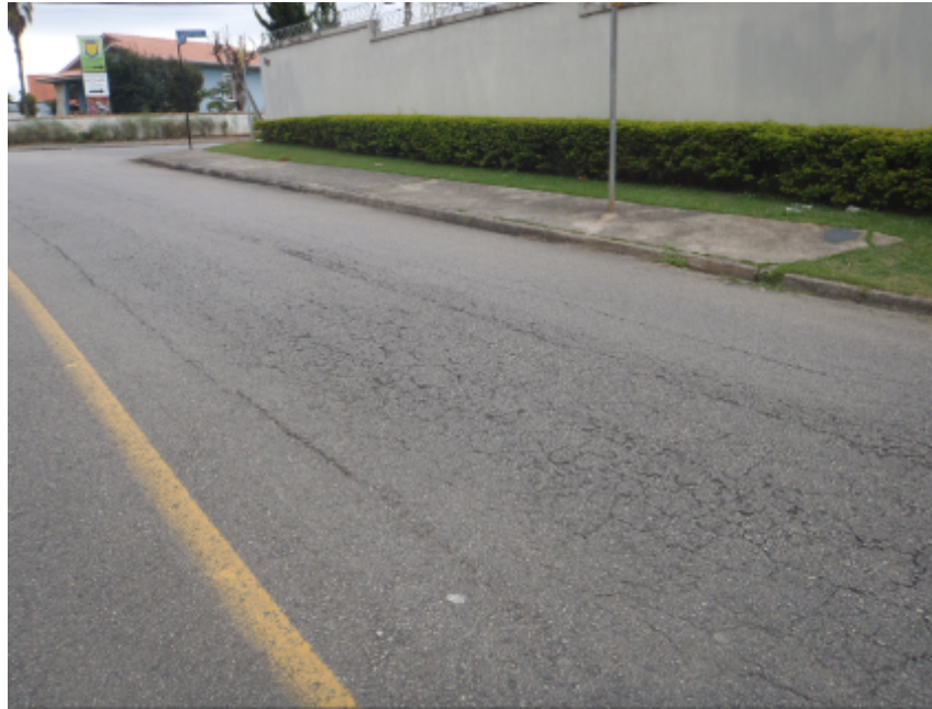
FIGURA 28 - TRECHO 2 CAP 50/70: TRINCAMENTO LONGITUDINAL E INTERLIGADO FONTE: AUTOR (2012)
