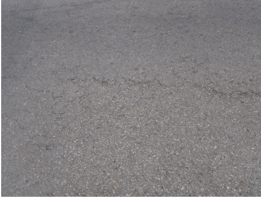
FIGURA 18 - TRECHO 1 CAP 50/70: TRINCAS LIGADAS
