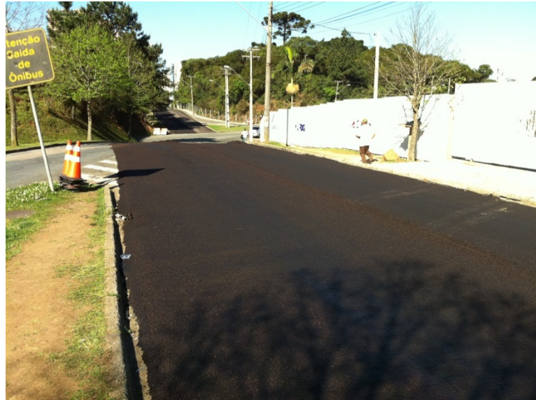
FIGURA 13 - PAVIMENTAÇÃO COM RECAPEAMENTO EM CONCRETO ASFÁLTICO COM LIGANTE DE BORRACHA EM CURITIBA
