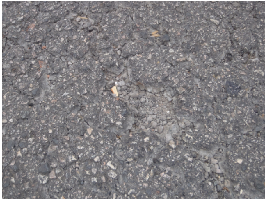
FIGURA 30 - TRECHO 2 CAP 50/70: DESAGREGAMENTO DE CBUQ
