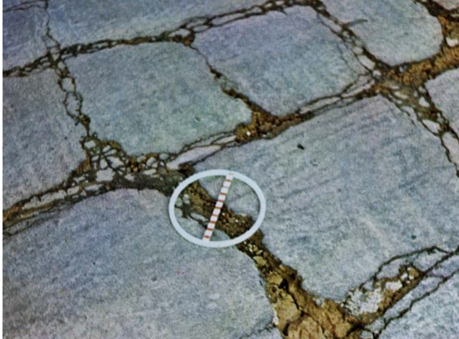
FIGURA 5 – TRINCA TIPO BLOCO
