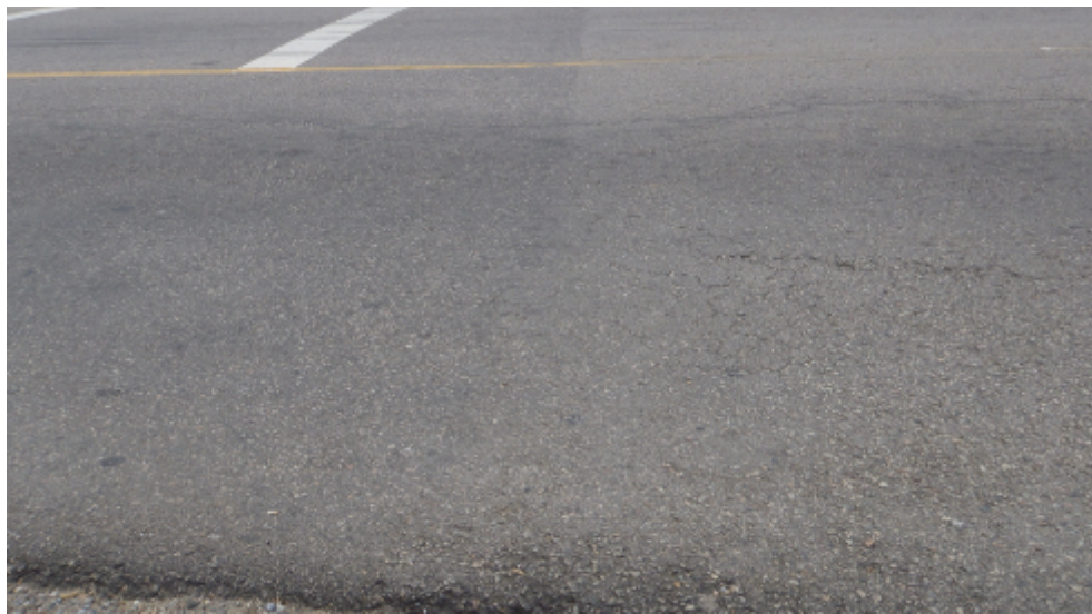
FIGURA 17 - TRECHO 1 CAP 50/70: FISSURAS LONGITUDINAIS E TRANSVERSAIS
