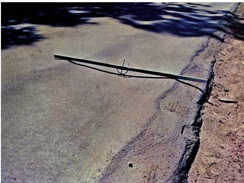
FIGURA 6 – AFUNDAMENTO DE TRILHO DE RODA
