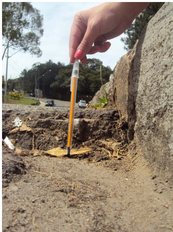
Figura 26 – Recalque na pista (ponto 1-4)
