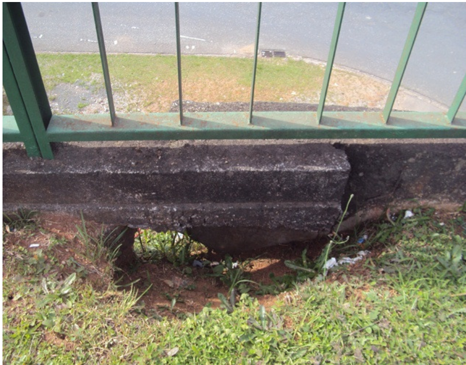
Figura 77 - Erosão do terreno na ala (ponto 8)
