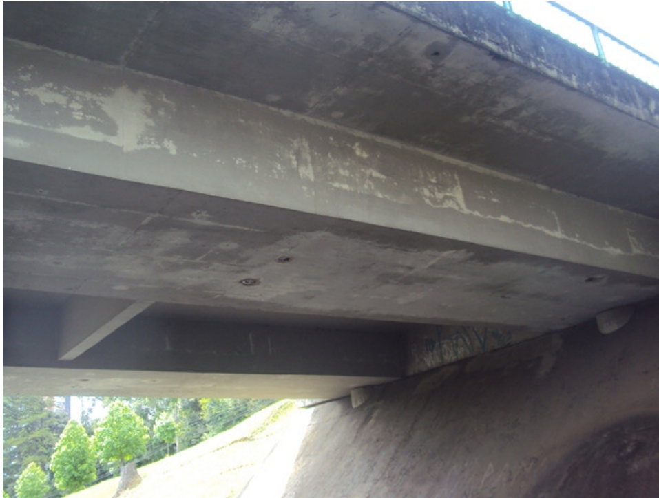
Figura 25 – Carbonatação no fundo de laje, vigas caixões e laje em balanço (todo)
