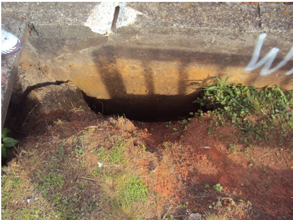
Figura 87 - Erosão do talude na ala (ponto 8)
