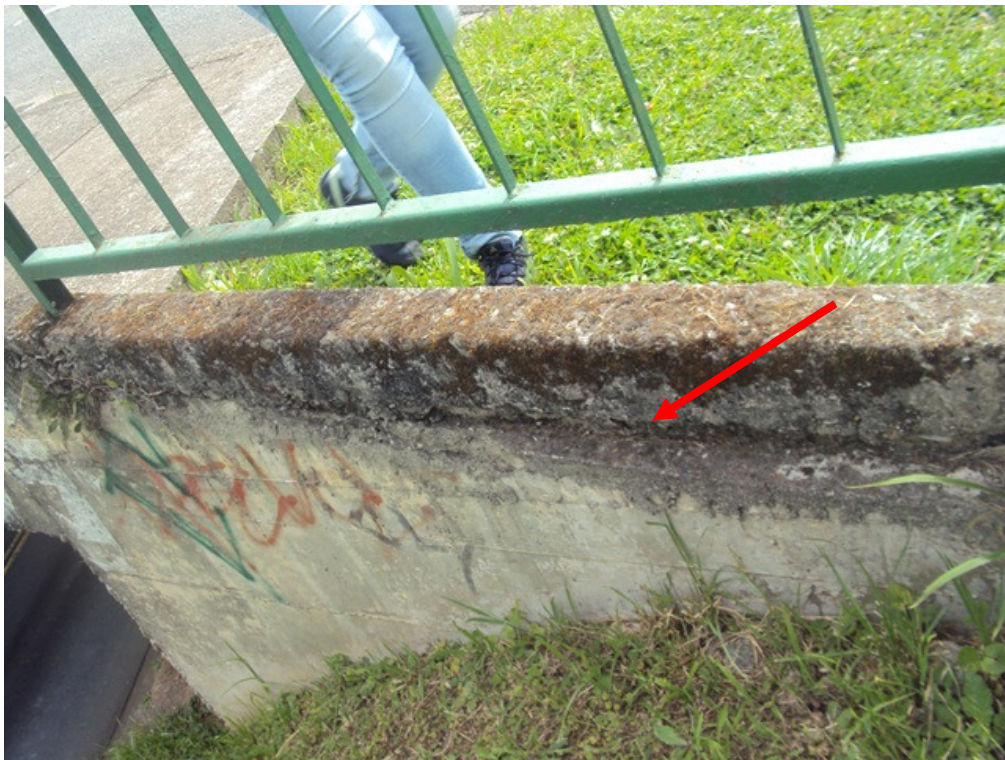
Figura 50 – Armadura exposta na ala (ponto 8)
