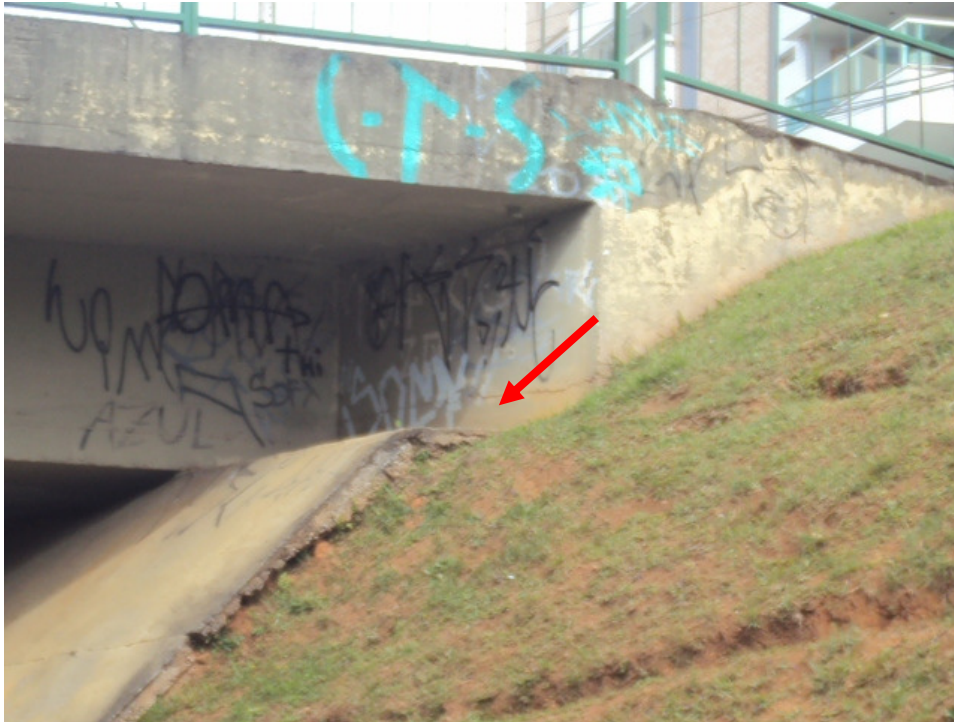
Figura 47 – Fissura na cortina (ponto 5)
