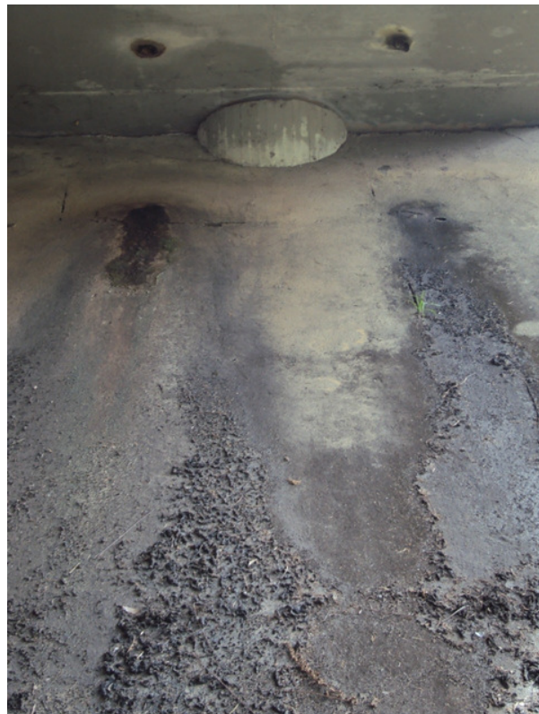
Figura 30 – Percolação de água na laje de proteção de talude (ponto 2)
