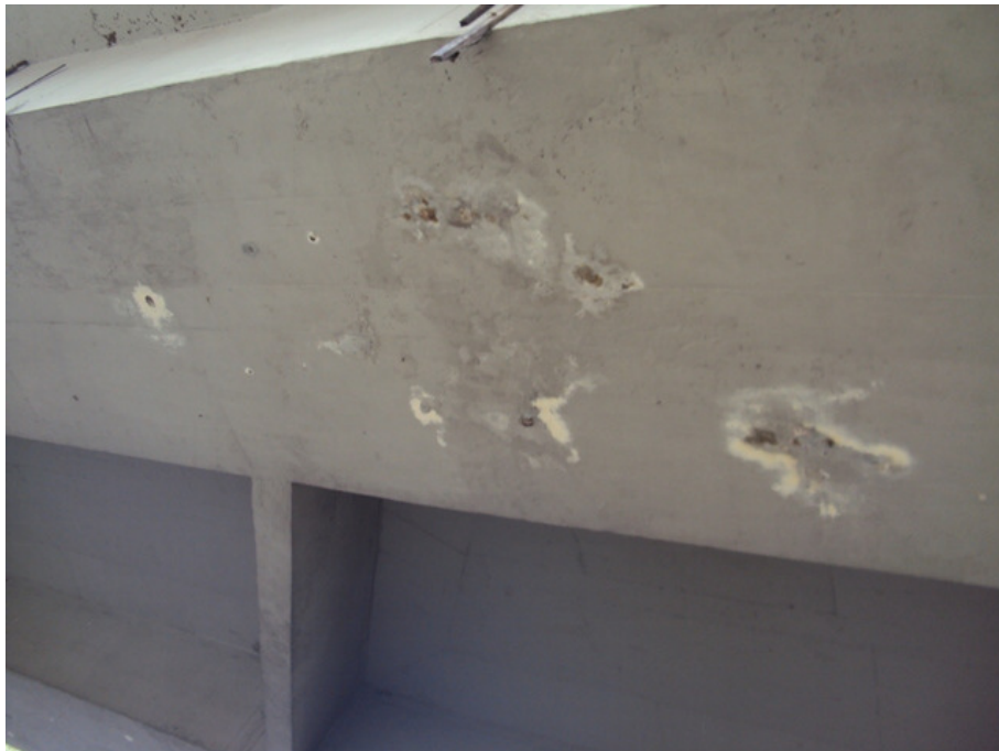
Figura 72 - Carbonatação na viga e nos drenos (todo)
