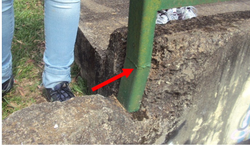
Figura 29 – Dano de colisão no guarda corpo (ponto 3)
