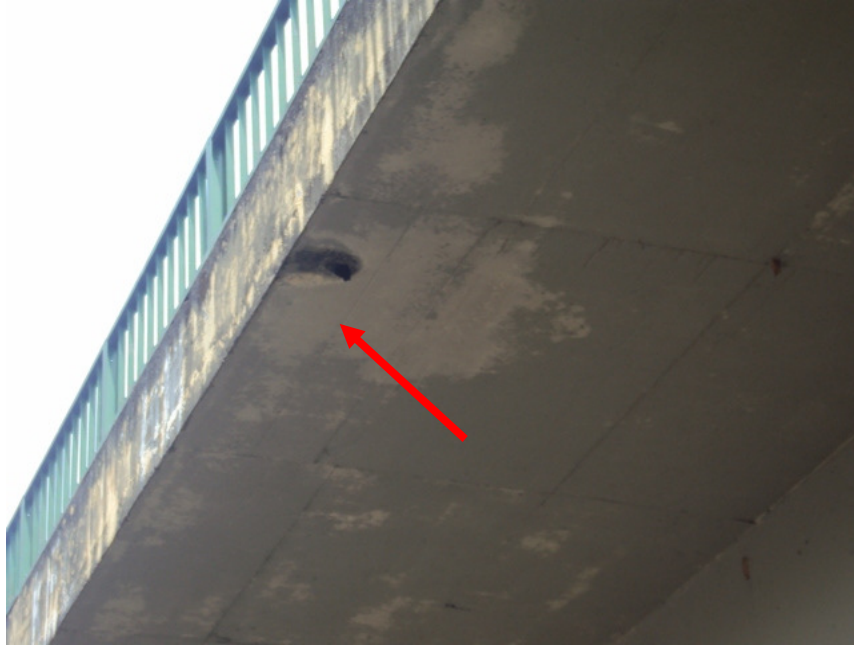
Figura 59 – Manchas de carbonatação na laje em balanço e dreno danificado (ponto 6-7)
