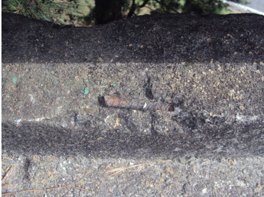
Figura 75 - Exposição de armadura na ala (ponto 5)
