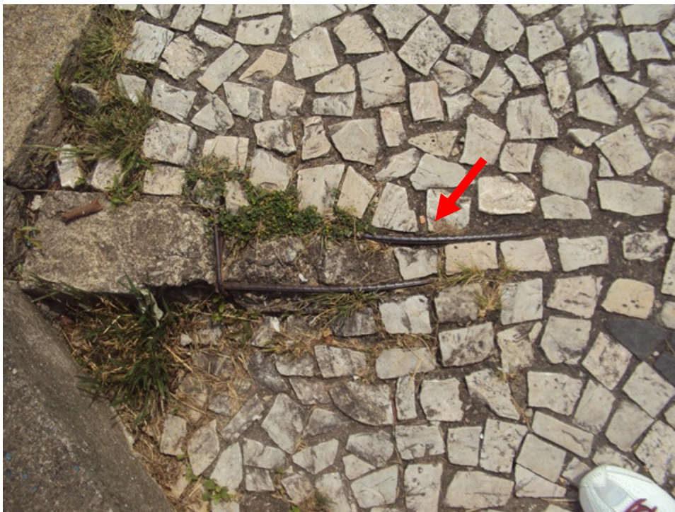
Figura 12 – Armadura exposta na ala (ponto 2)
