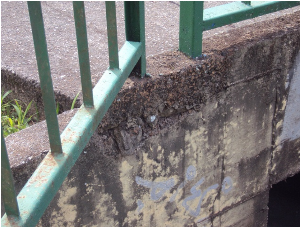
Figura 51 – Ninho de concretagem na ala (ponto 7)
