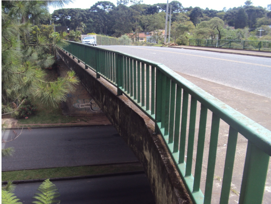
Figura 31 – Percolação na laje em balanço (ponto 1-2)
