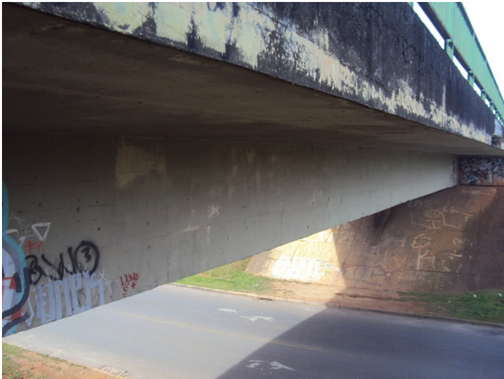
Figura 90 - Percolação ao longo da laje em balanço (ponto 5-8)
