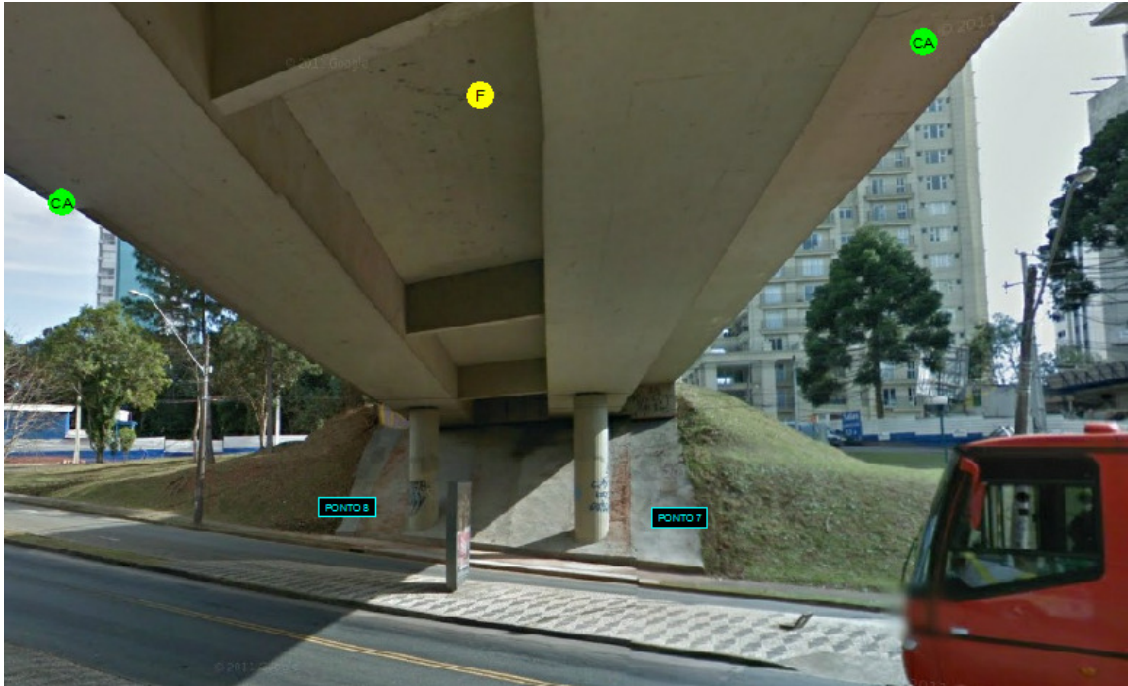
Figura 36 – Mapeamento Rua Luiz Mazzeto Baggio – Vista inferior face norte
