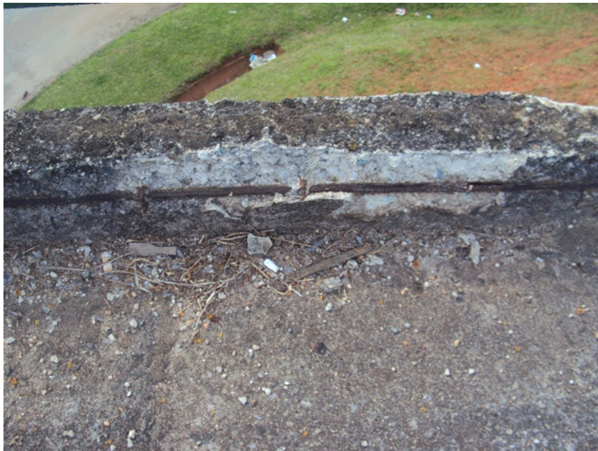
Figura 84 - Exposição e corrosão da armadura da ala (ponto 7)
