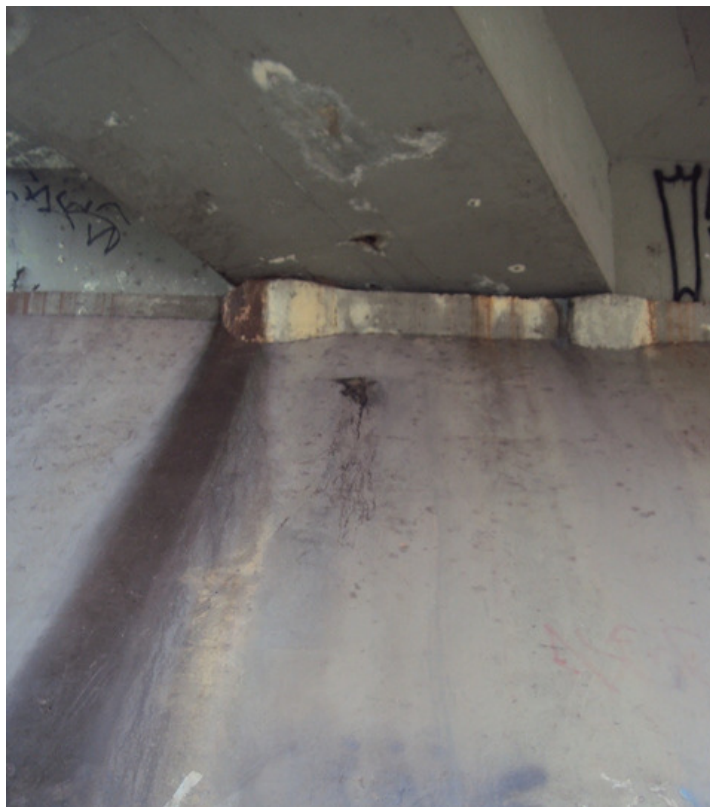
Figura 76 - Lixiviação e Carbonatação no pilar (pontos 5 e 6)
