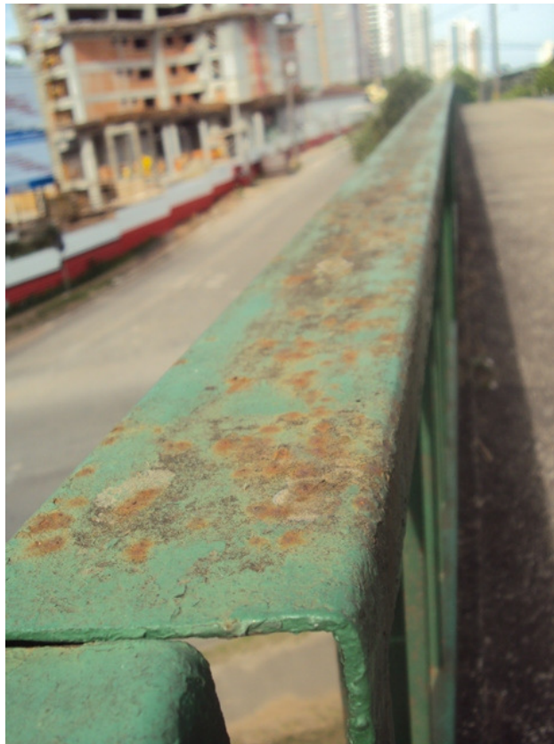
Figura 73 - Corrosão do guarda-corpo (todo)
