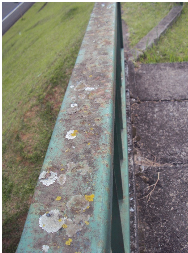
Figura 62 – Corrosão no guarda corpo (todo)
