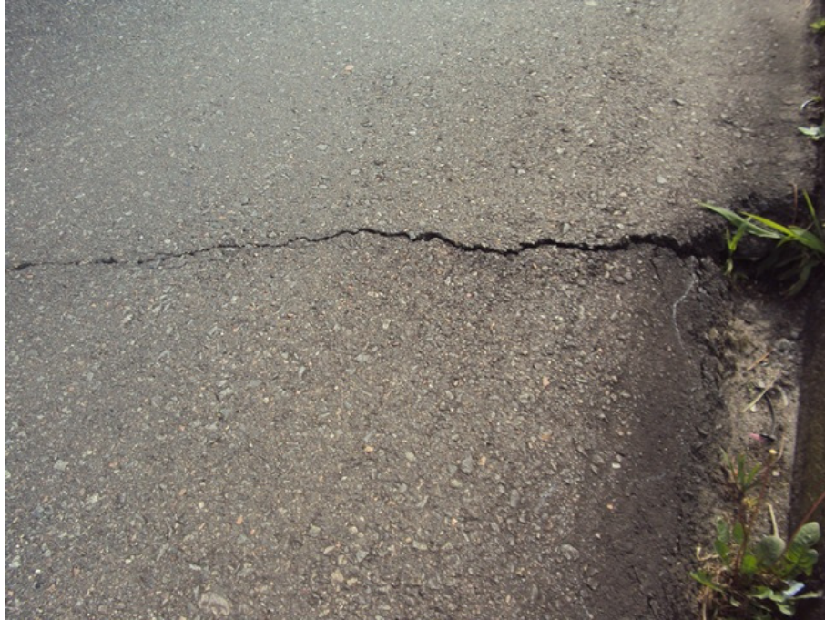
Figura 71 - Fissura na cabeceira da pista (ponto 1)
