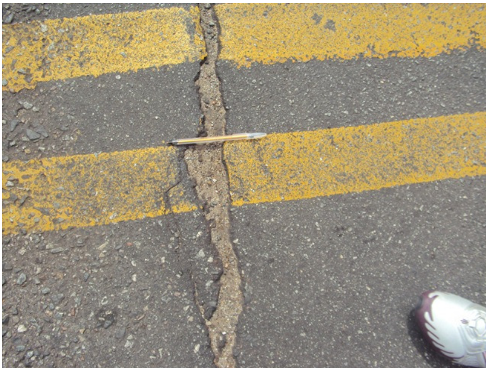
Figura 24 – Fissura na cabeceira da pista (ponto 2-3)
