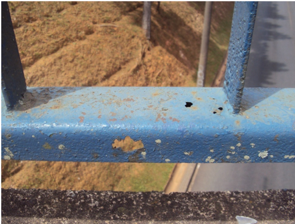
Figura 13 – Corrosão no guarda corpo (todo)
