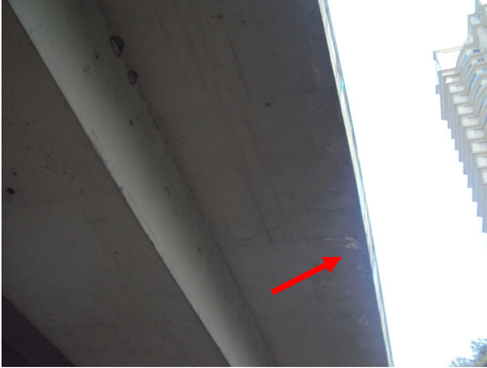
Figura 38 – Carbonatação na laje em balanço (ponto 6)
