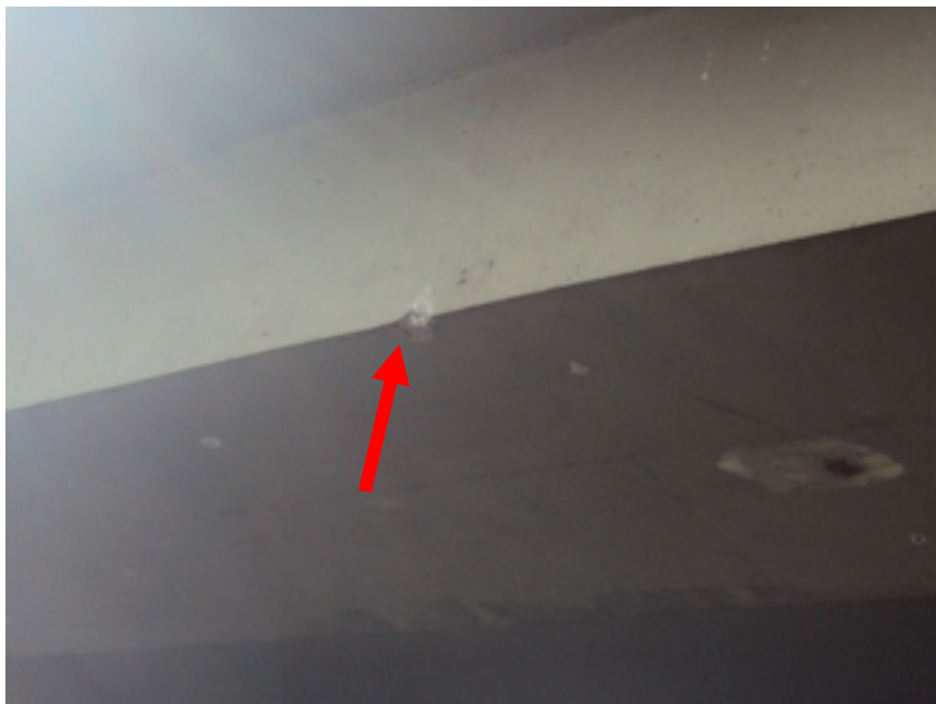
Figura 74 - Dano de colisão (entre os pontos 6 e 7)
