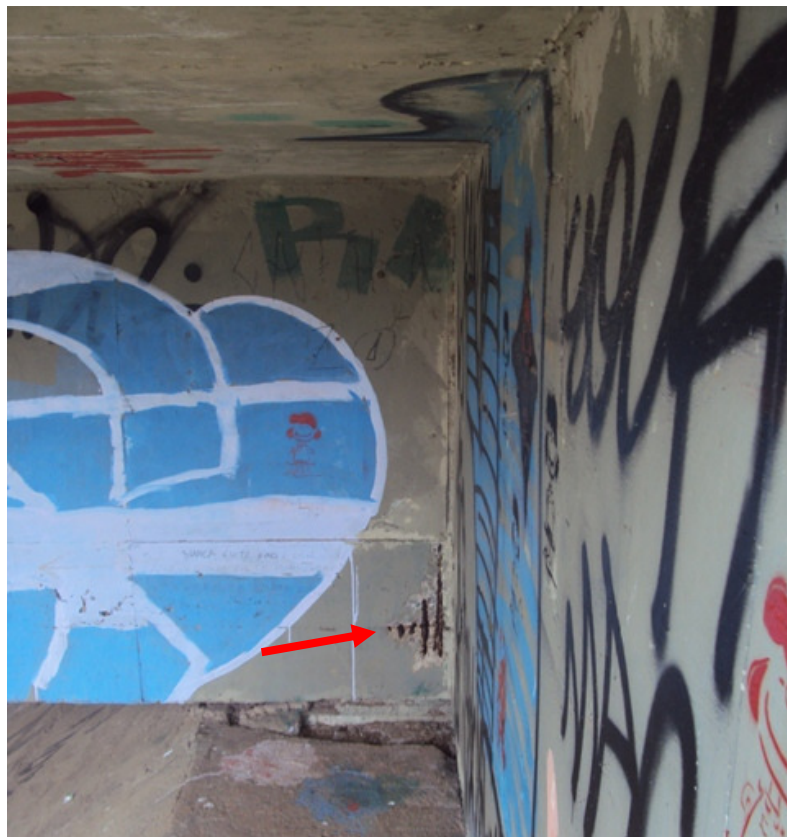
Figura 60 – Armadura exposta e corroída na viga caixão, na ligação com a cortina (ponto 5)
