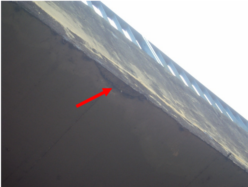
Figura 16 – Deslocamento do concreto na laje em balanço (entre os pontos 3-4)
