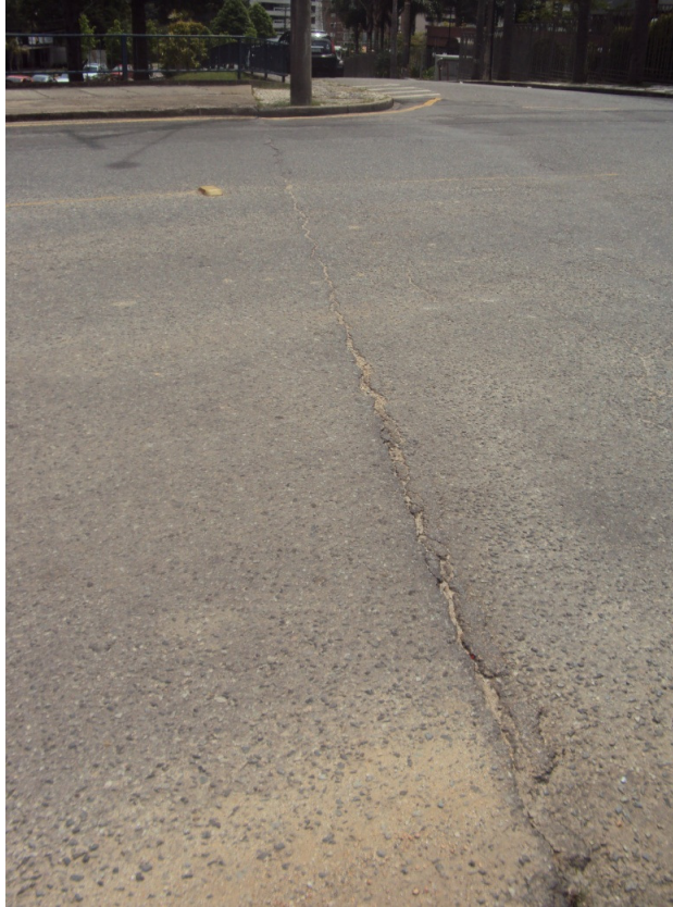
Figura 9 – Fissura na cabeceira da pista (ponto 1-4)
