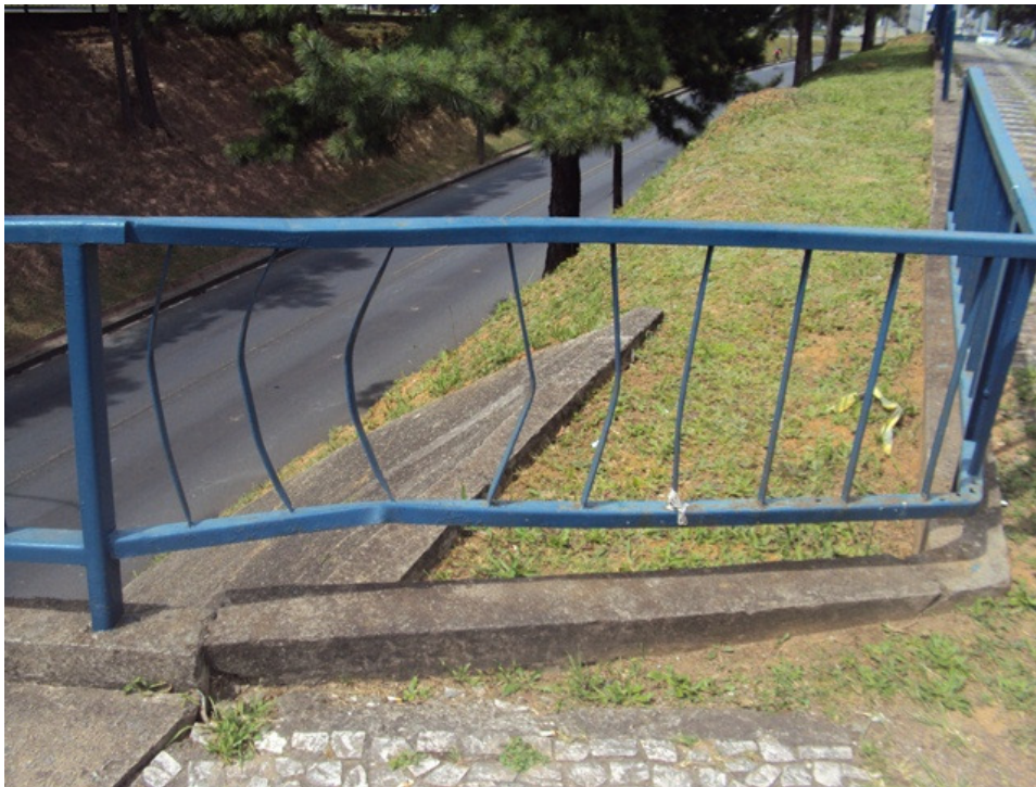
Figura 11 – Dano por colisão no guarda corpo (ponto 1)
