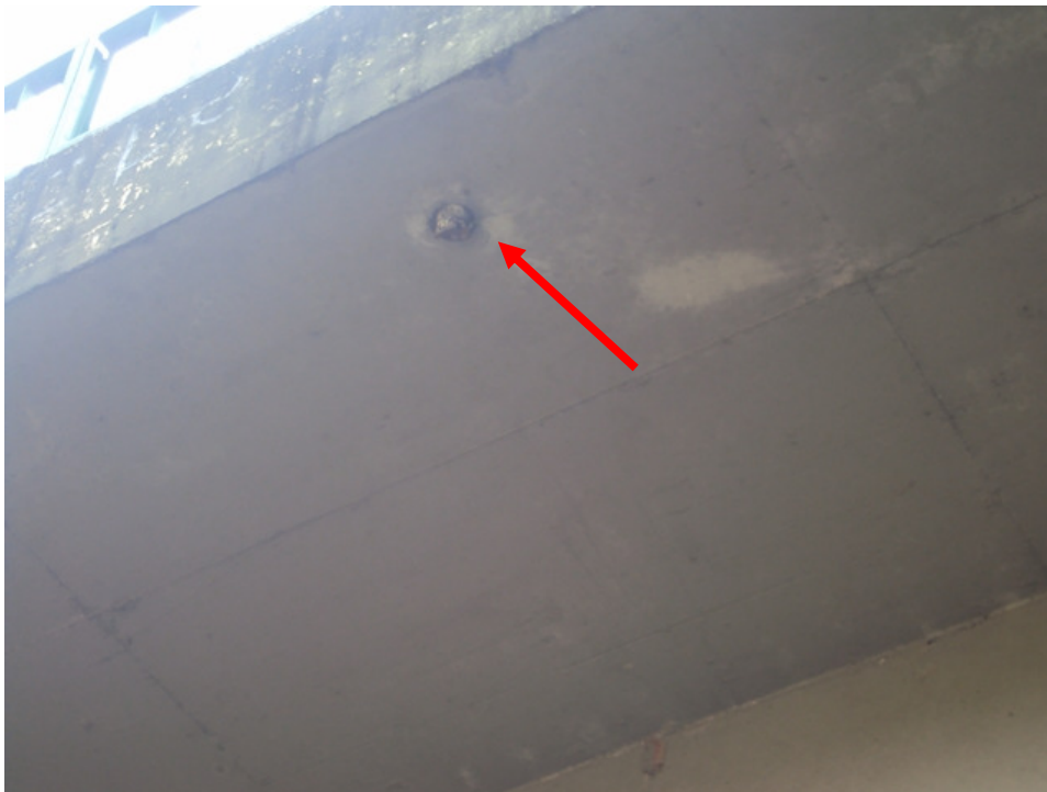
Figura 52 – Dreno danificado na laje em balanço
