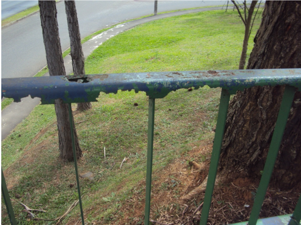
Figura 40 – Corrosão no guarda corpo (ponto 1)
