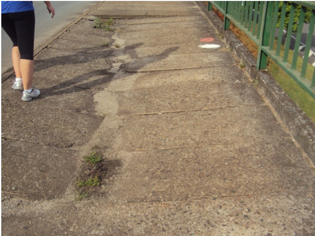
Figura 89 - Afundamento do passeio (entre os pontos 3-4)
