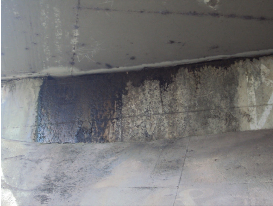
Figura 15 – Percolação de água na cortina (pontos 7-8)
