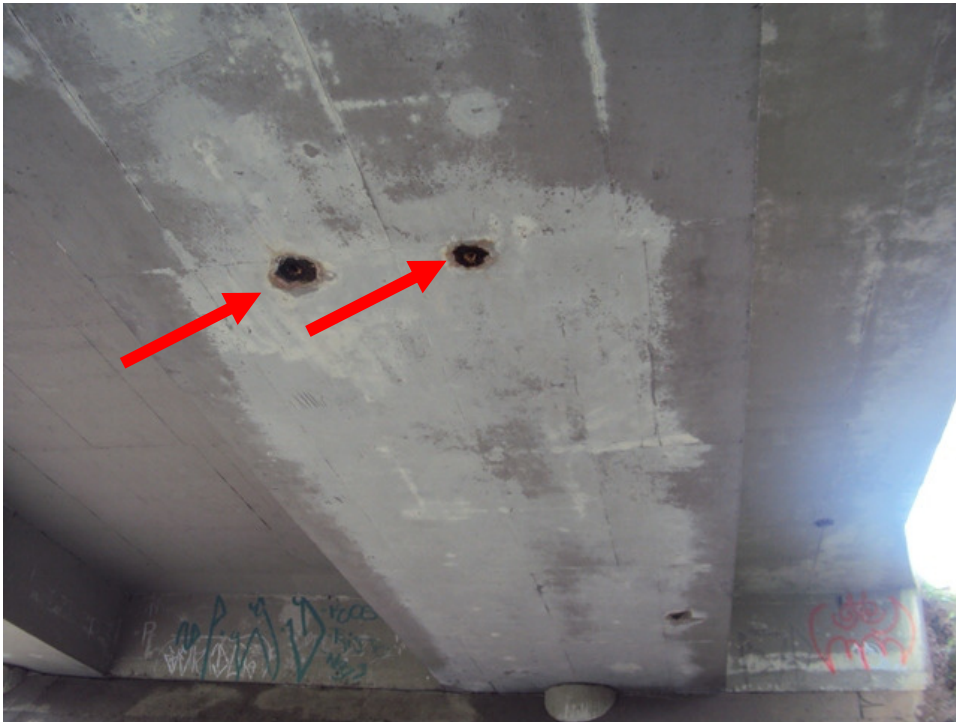
Figura 28 – Drenos danificados (todos os drenos apresentam danos)
