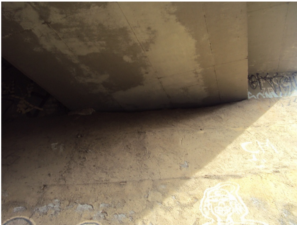
Figura 48 – Carbonatação no fundo da viga caixão (todo)
