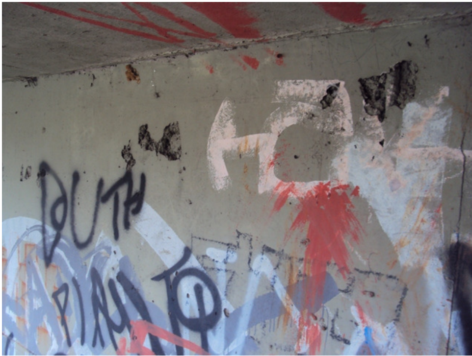
Figura 86 - Vazios de concretagem, com exposição da armadura na viga (pontos 5-6)
