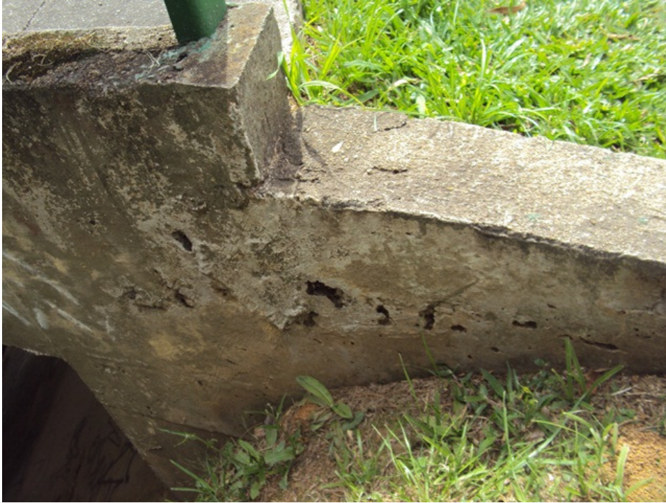
Figura 27 – Ninho de concretagem na ala (ponto 7)
