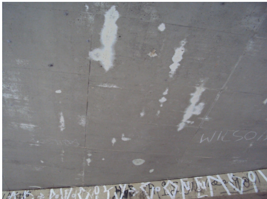
Figura 10 – Carbonatação no fundo de laje (toda estrutura)
