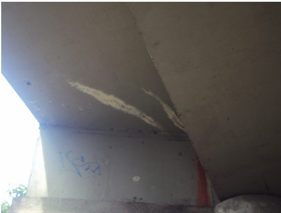
Figura 78 - Estalactite na laje em balanço (ponto 8)
