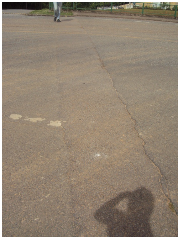
Figura 46 – Fissura na cabeceira da pista (ponto 2-3)
