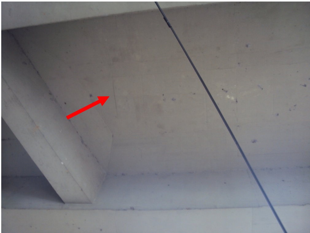
Figura 37 – Fissuras no fundo de laje (pontos 5-6)
