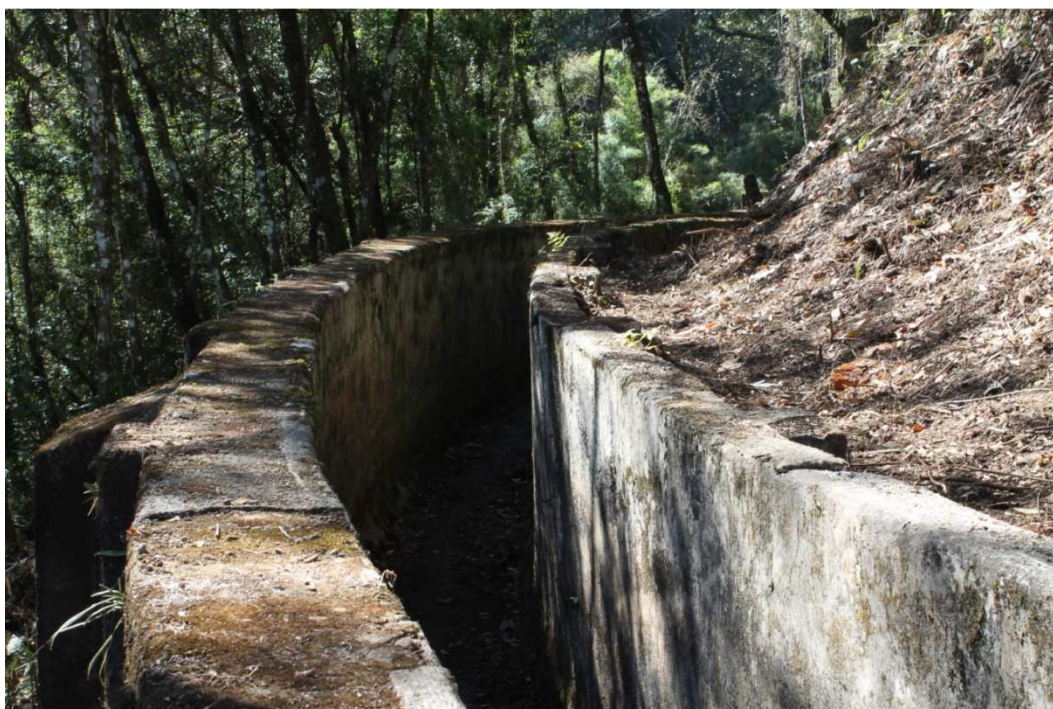
Figura 19 – Canal de adução da MCH de Rio Branco do Sul/PR
