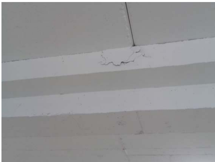
Figura 49: Fissuração e desagregação de concreto em apoio de laje pré-moldada – Amostra 12
