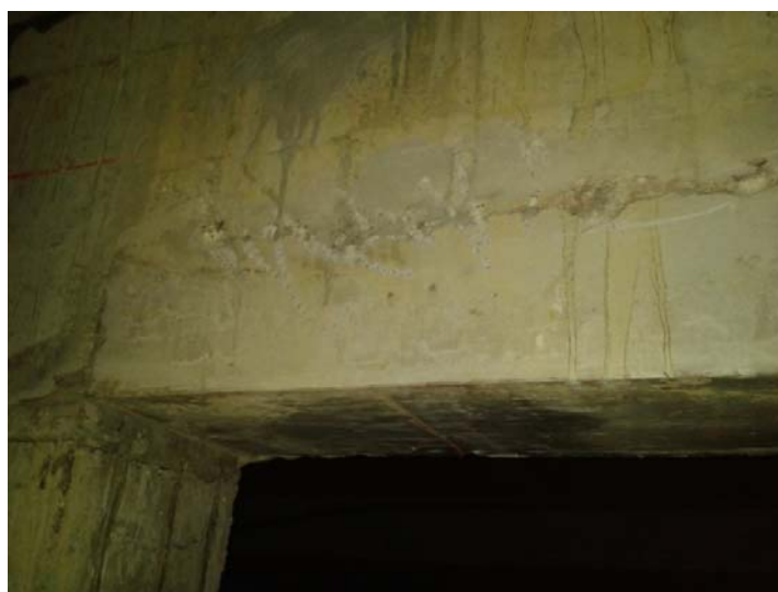
Figura 30: Evolução das Fissuras
