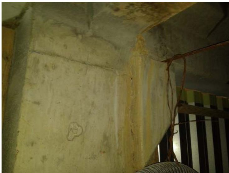
Figura 47: Fissuração em console – Amostra 43
