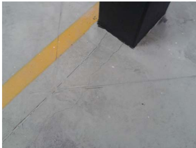
Figura 44: Fissuração do piso após reparos
