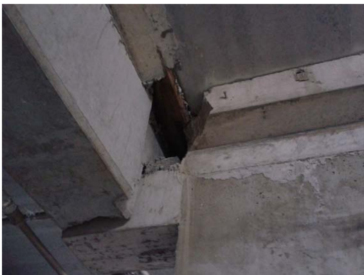
Figura 52: Falha de concretagem em apoio – Amostra 32
