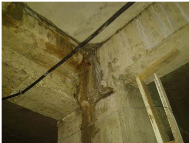
Figura 53: Falha de concretagem em apoio – Amostra 50
