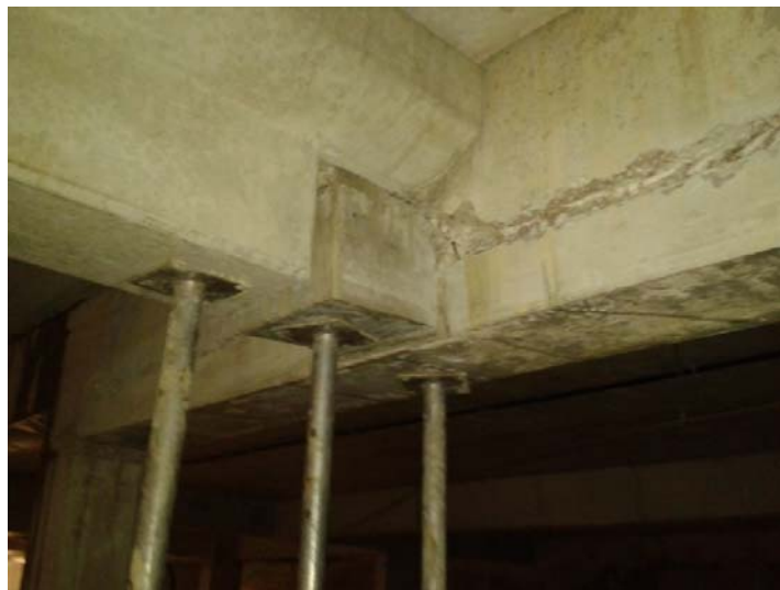
Figura 29: Descolamento da emenda na viga (limpeza)
