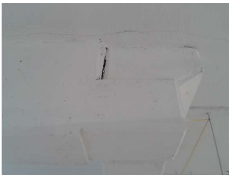
Figura 50: Fissuração na laje pré-moldada e console – Amostra 26
