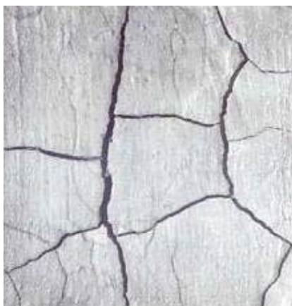
Figura 4: Retração do concreto.
