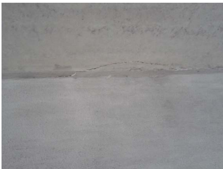
Figura 48: Fissuração em apoio de laje pré-moldada – Amostra 15
