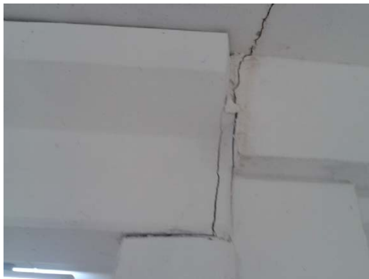
Figura 42: Trinca na laje e viga pré-moldada.
