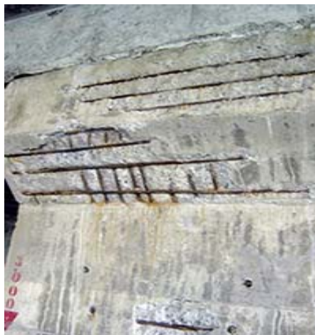
Figura 1: Manifestações patológicas em uma estrutura de concreto armado
