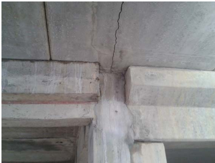
Figura 41: Trinca na laje pré-moldada.
