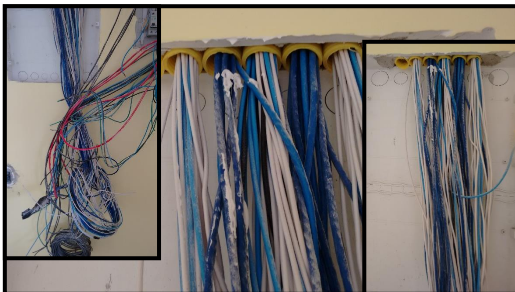
Figura 3 - Fotografia de Cabos e Infraestrutura em uma instalação com IHC Fonte: Autoria própria.
