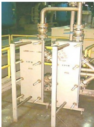
Figura 15 - Trocadores de calor Fonte: Santiago, Becker e Kern (2004).
