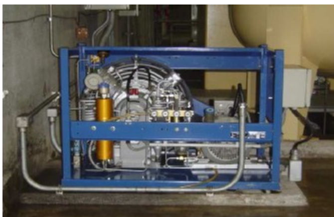
Figura 26 - Compressor de ar Fonte: Santiago, Becker e Kern (2004).
