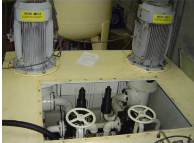
Figura 14 - Visão superior das moto bombas Fonte: Santiago, Becker e Kern (2004).
