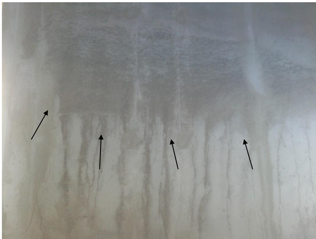
Figura 18 – Defeito C: Segregação do concreto superior a 2m acima do piso
