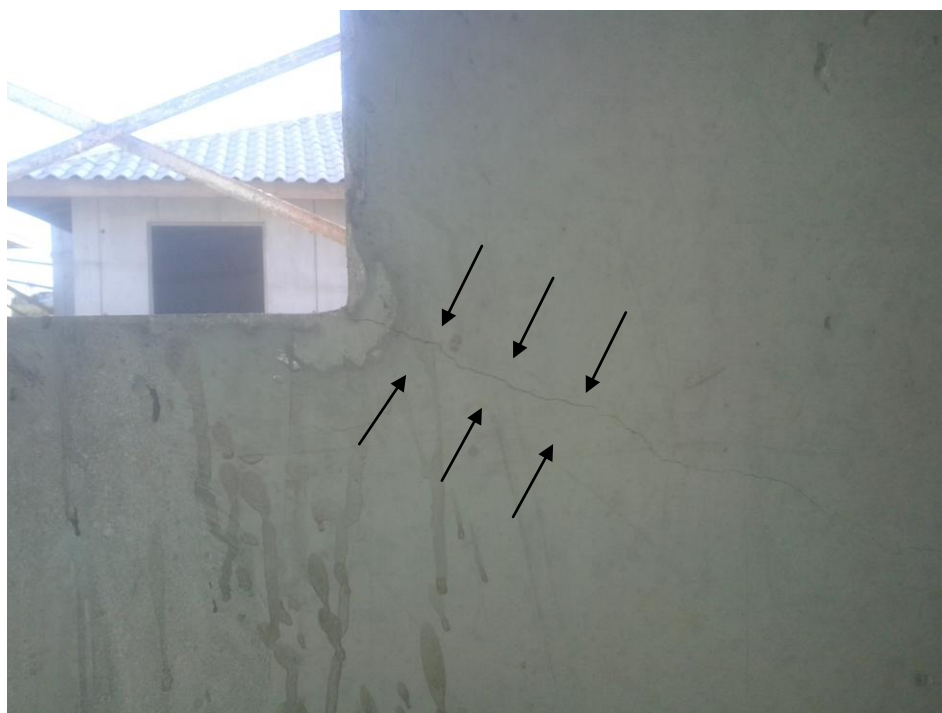
Figura 9 – Fissura 45°: Fissuras a 45° de aberturas de portas e janelas
