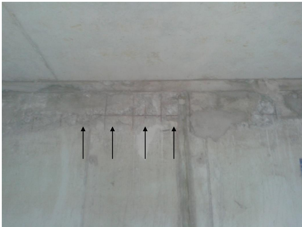
Figura 19 – Armadura exposta: Ferragem exposta na superfície da parede Fonte: Autoria Própria
