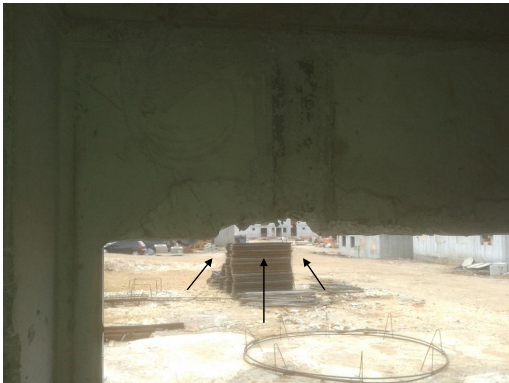
Figura 21 – Defeito contramarco: Contramarco das janelas quebrado
