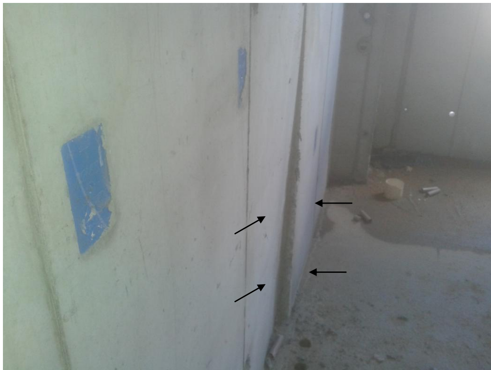
Figura 22 – Abertura placas: Aumento indesejado na espessura das paredes Fonte: Autoria Própria
