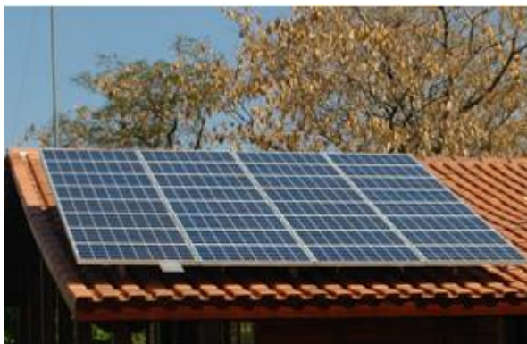
Figura 8 – Painel fotovoltaico instalado no telhado de uma casa. Fonte: www.cresesb.cepel.br
