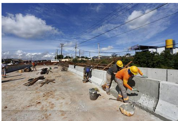
Figura 24 – Vista frontal do viaduto na Rodovia PR 323 em fase de execução do alargamento Fonte: AAD Projetos Consultoria e Engenharia.
