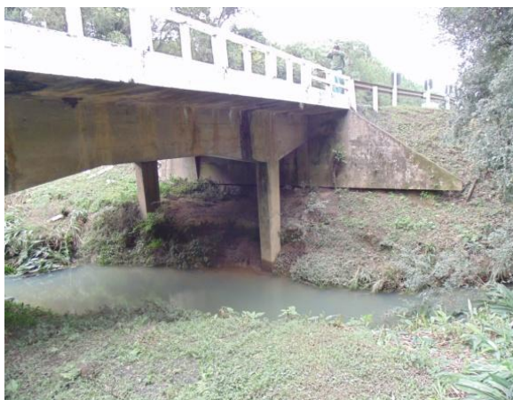
Figura 46 – Vista lateral da ponte original sobre o rio Lajeado Fonte: AAD Projetos Consultoria e Engenharia.
