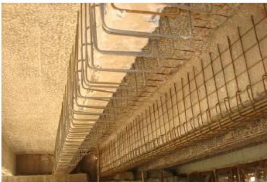
Figura 16 – Armaduras de reforço das vigas antigas de uma ponte alargada Fonte: VITÓRIO (2013).
