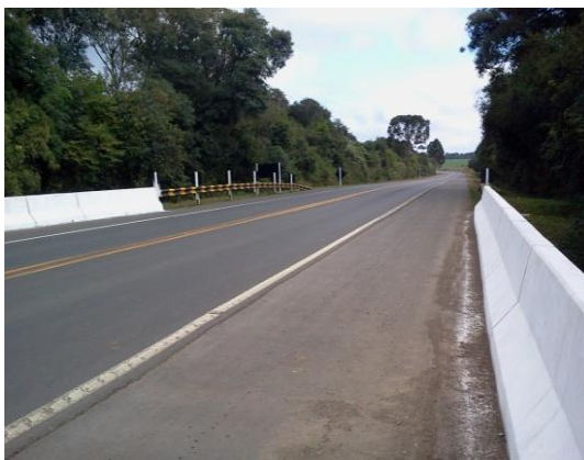
Figura 37 – Vista frontal da ponte alargada sobre o rio Vargem Grande Fonte: AAD Projetos Consultoria e Engenharia.
