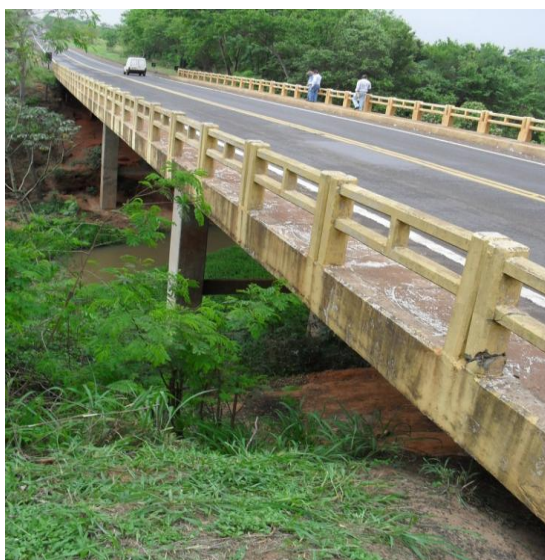
Figura 26 – Vista lateral da ponte original sobre o rio Tigre Fonte: AAD Projetos Consultoria e Engenharia.
