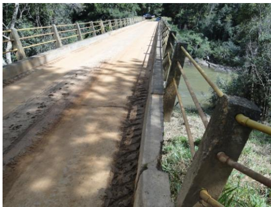
Figura 27 – Vista frontal da ponte original sobre o rio Fortaleza Fonte: AAD Projetos Consultoria e Engenharia.
