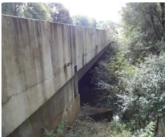
Figura 34 – Vista lateral da ponte alargada sobre o rio Água Amarela I Fonte: AAD Projetos Consultoria e Engenharia.
