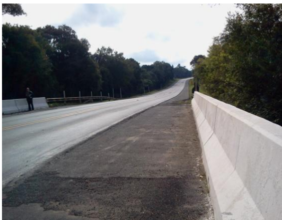
Figura 33 – Vista frontal da ponte alargada sobre o rio Água Amarela I Fonte: AAD Projetos Consultoria e Engenharia.
