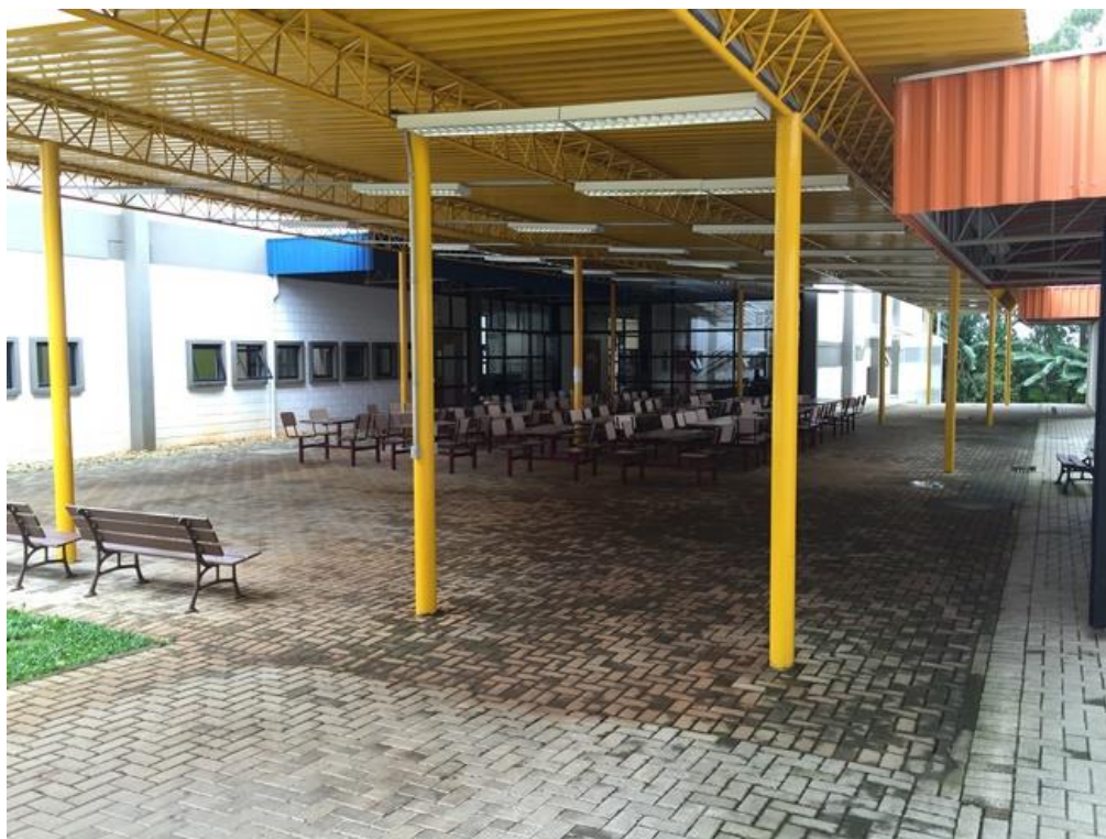
Figura 19 – Detritos visíveis em área pavimentada com blocos de concreto intertravados
