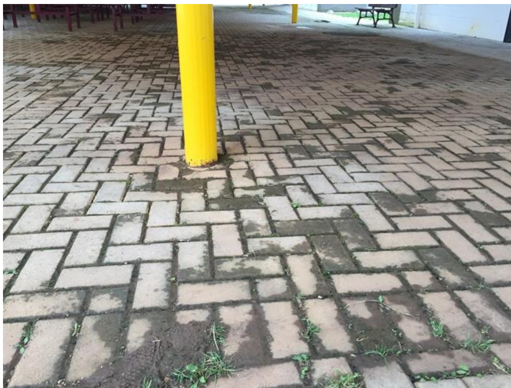
Figura 21 – Acúmulo de detritos em área pavimentada com blocos de concreto intertravados
