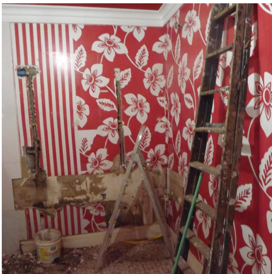
Fotografia 5 – Paredes não acabadas. Fonte: Os Autores, 2013.
