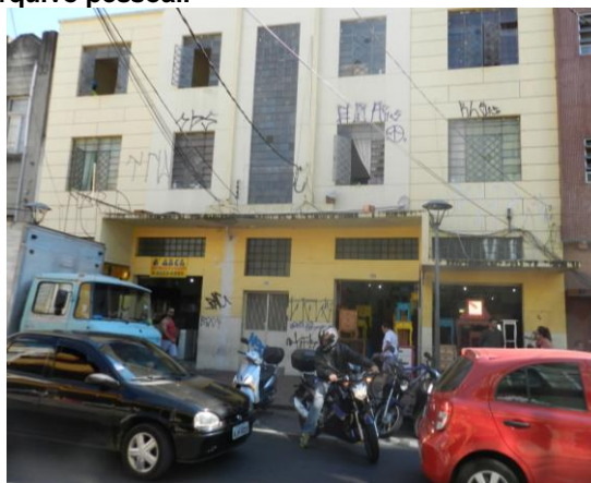
Figura 32 - Edificação degradada na Rua Riachuelo Fonte: Arquivo pessoal.
