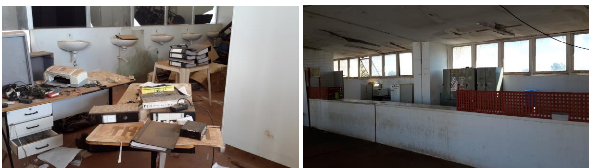
Figura 64 e Figura 65: Condições precárias nas salas do autódromo (à esquerda); Foto: Condições precárias do autódromo (à direita)
