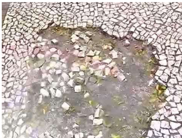
Fotografia 8 - Degradação do Calçamento em Petit-Pavê na Praça Rui Barbosa Fonte: elaborado pelo autor com base em visita ao local em 2017.
