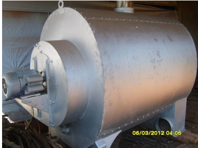
Figura 14 - Aquecedor a Biomassa
